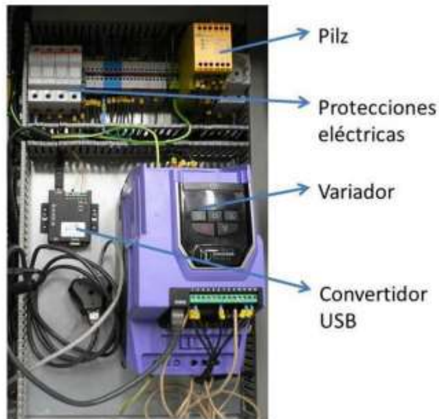
Figura 27: Interior del armario principal.
