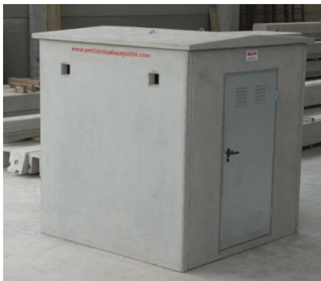
Figura 32. Caseta pozo con puerta de seguridad.
