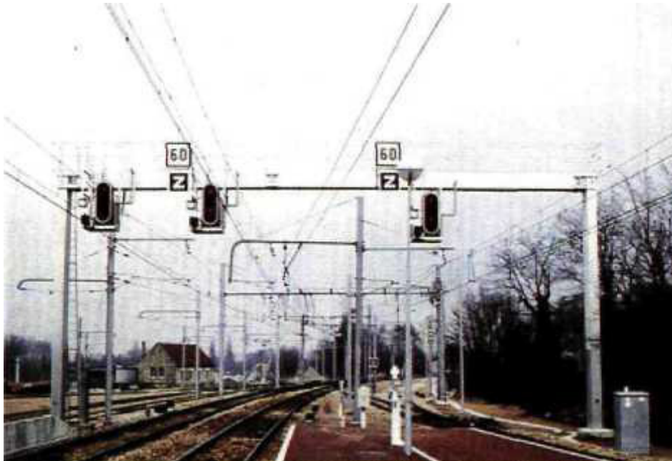
Figura 4: Conjunto de señales de velocidad montadas en pórtico de aluminio
