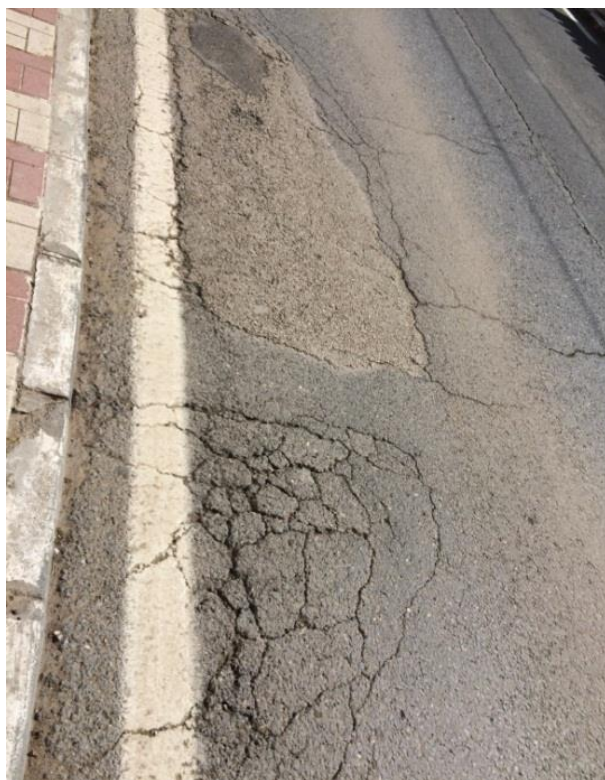
FIGURA 18.22- Tras la intersección con la calle escuelas apreciamos agotamiento del firme
