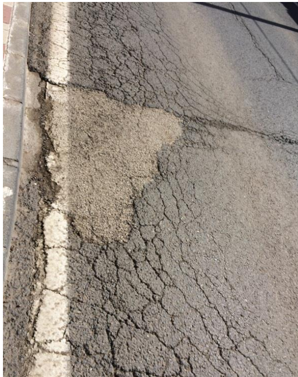
FIGURA 18.23- Detalle agotamiento del firme
