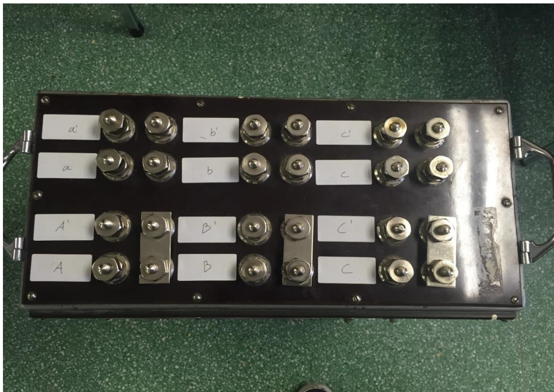
Figura 4.5.1. Transformador trifásico de 5KVA con dos bobinas por devanado.
