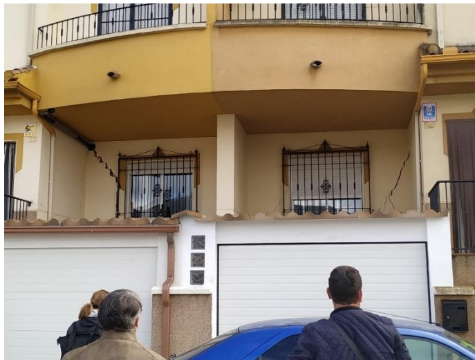
Figura 49. Daño estructural observado en viviendas modelizadas en Atarfe
