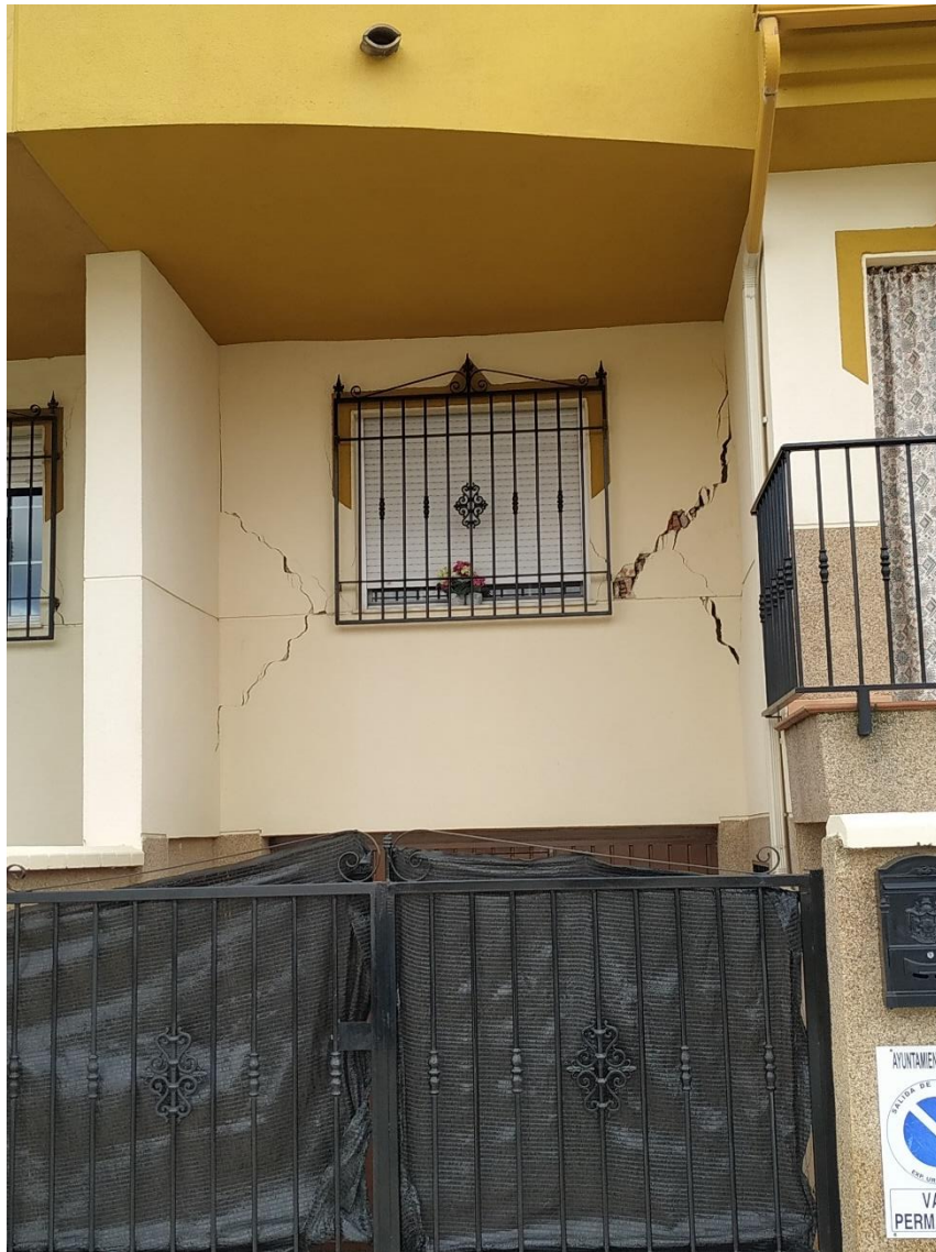
Figura 50. Detalle daño estructural observado en viviendas modelizadas en Atarfe
