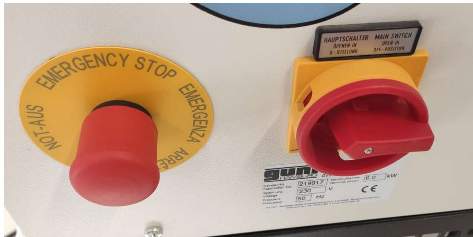
Ilustración 5.9 Interruptores eléctricos ET-792 desactivados
