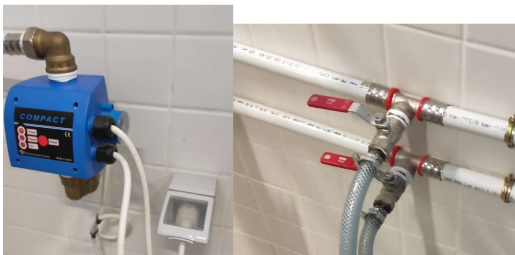
Ilustración 5.8 Bomba de impulsión agua refrigeración (izquierda) llaves de corte agua refrigeración (derecha)
