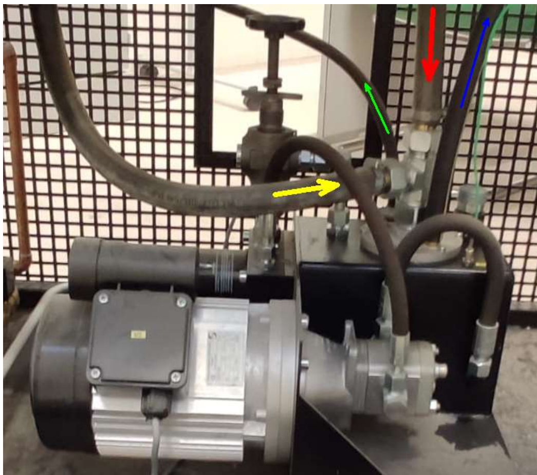
Ilustración 4.10 Elementos de lubricación turbina ET-792
