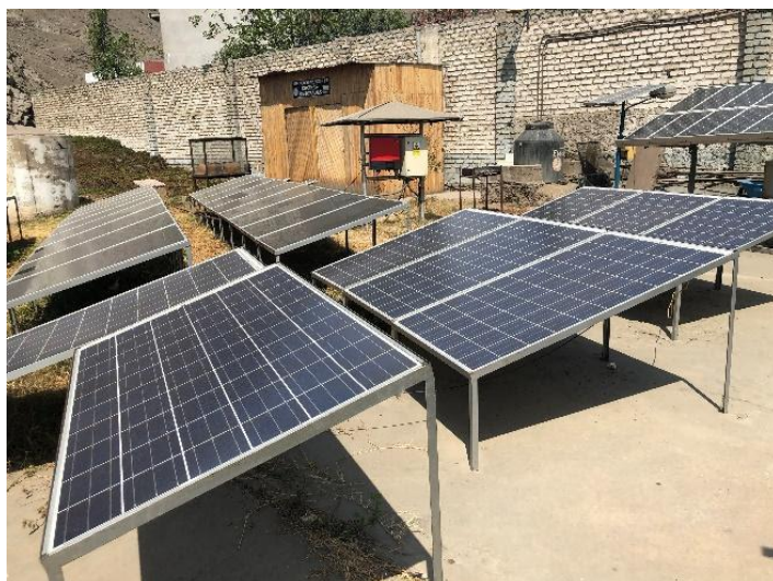
Figura 6. Instalación fotovoltaica localizada en Lima tras los cambios realizados en su generador fotovoltaico. Fuente: UJAEN
