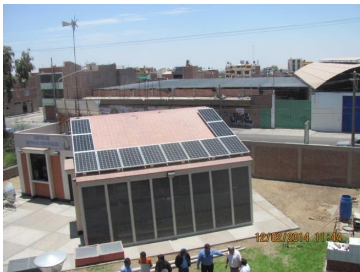
Figura 4. Instalación fotovoltaica localizada en Tacna. Fuente: Espinoza R, et al. (2019)
