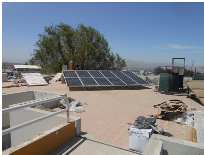
Figura 3. Instalación fotovoltaica localizada en Arequipa. Fuente: Espinoza R, et al. (2019)
