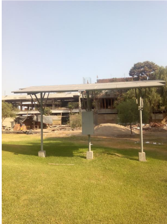
Figura 12: Instalación fotovoltaica localizada en la UNI. Fuente: UJAEN
