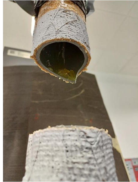
Figura 109. Detalle de la rotura
