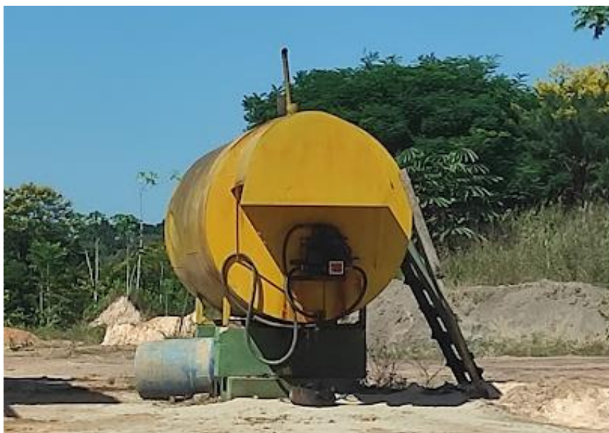
Figura 47: Tanque de almacenamiento de combustible.
