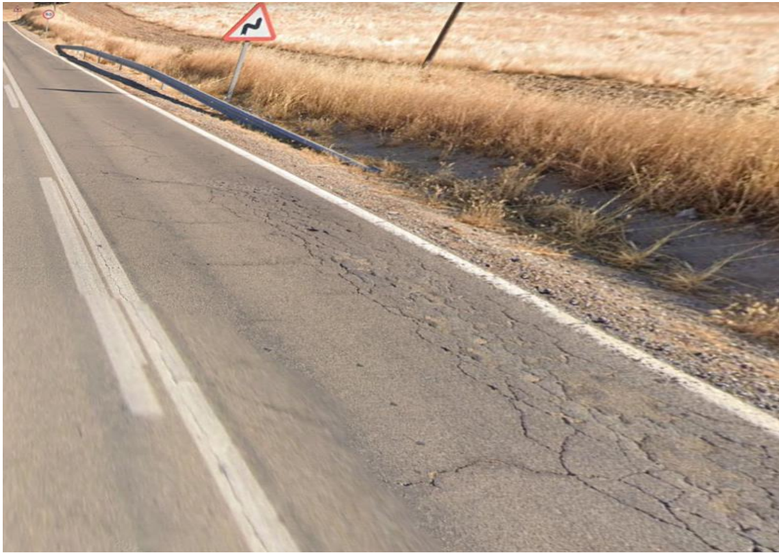
Figura 3. Estado actual del firme
