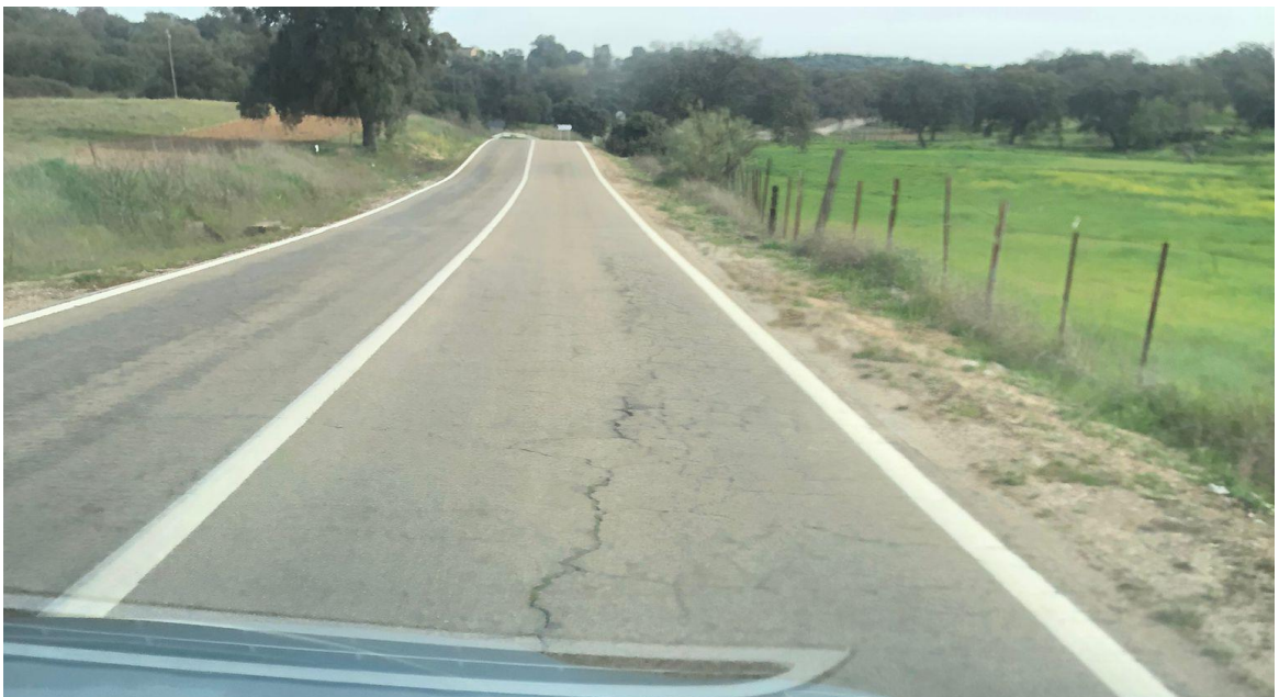
Figura 5. zonas hundidas (sentido opuesto) y piel de cocodrilo en carril derecho
