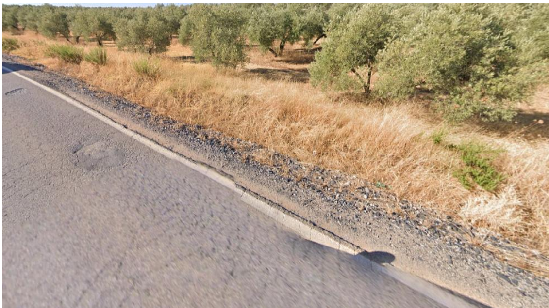
Figura 2. Ausencia de Cunetas estructurales
