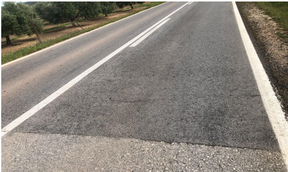
Figura 2. Transición entre capas de pavimentos de distintas edades.
