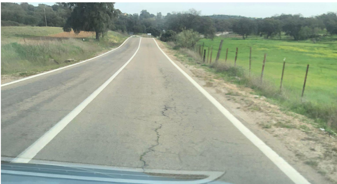
Figura 4. zonas hundidas (sentido opuesto) y piel de cocodrilo en carril derecho
