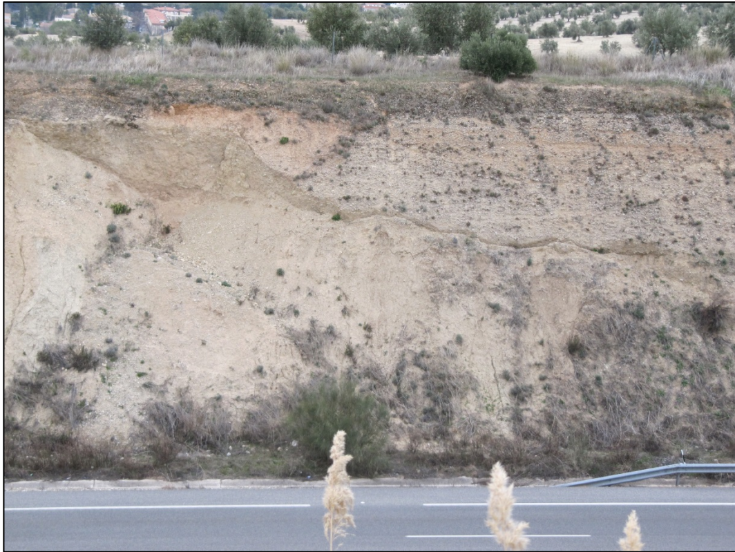
Imagen 4. 9. Cavidad del talud
