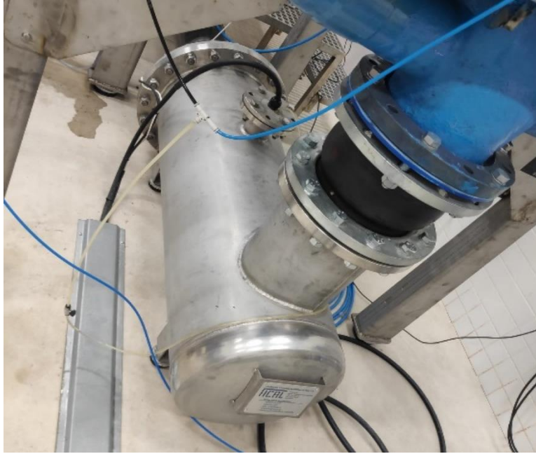
Fotografía 2: Bomba acoplada al canal del laboratorio de la E.P.S.L.
