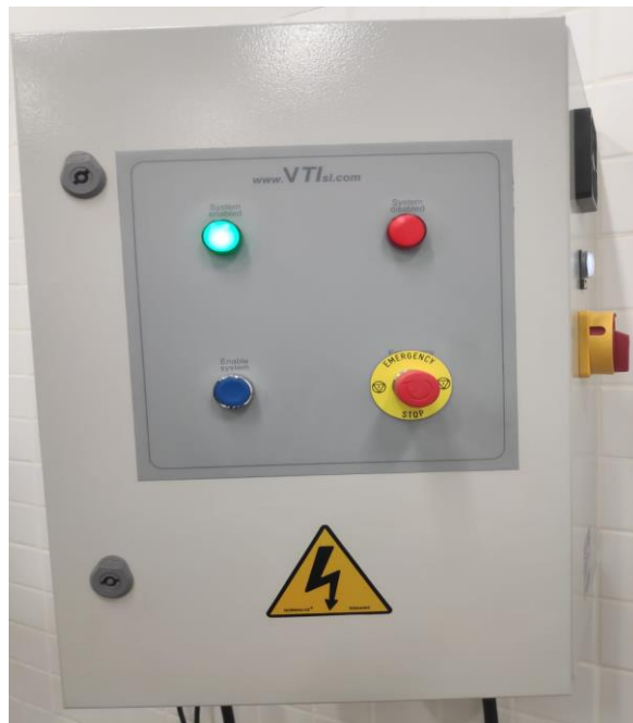
Fotografía 3: Cuadro de control de la Bomba del canal del laboratorio de la E.P.S.L.
