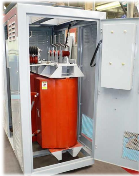
Figura 15. Ejemplo transformador tipo seco encapsulado en resina epóxica tipo europeo catálogo de DEMSA.
