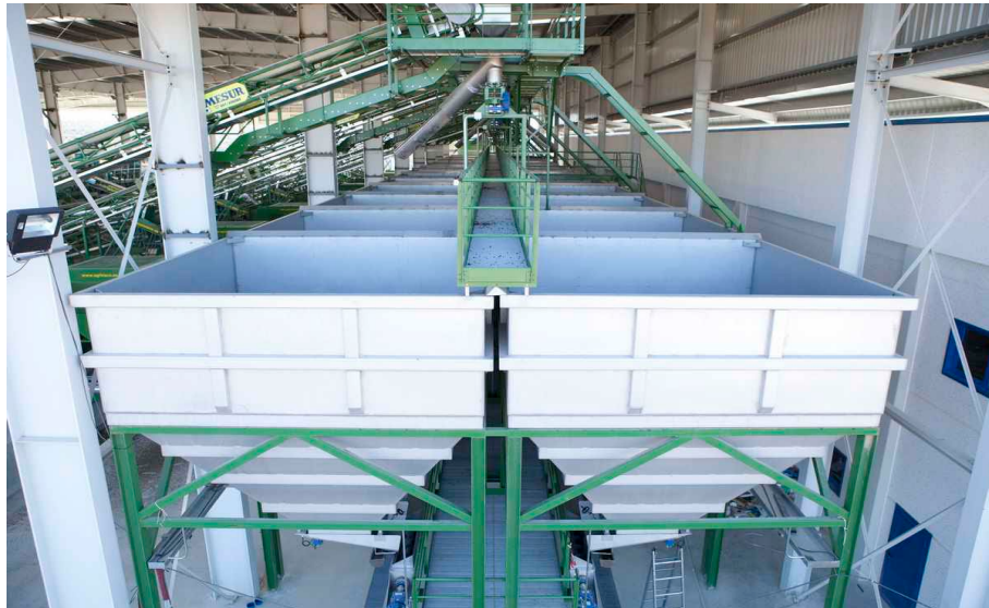
Figura 4.5. Tolva de recepción.
