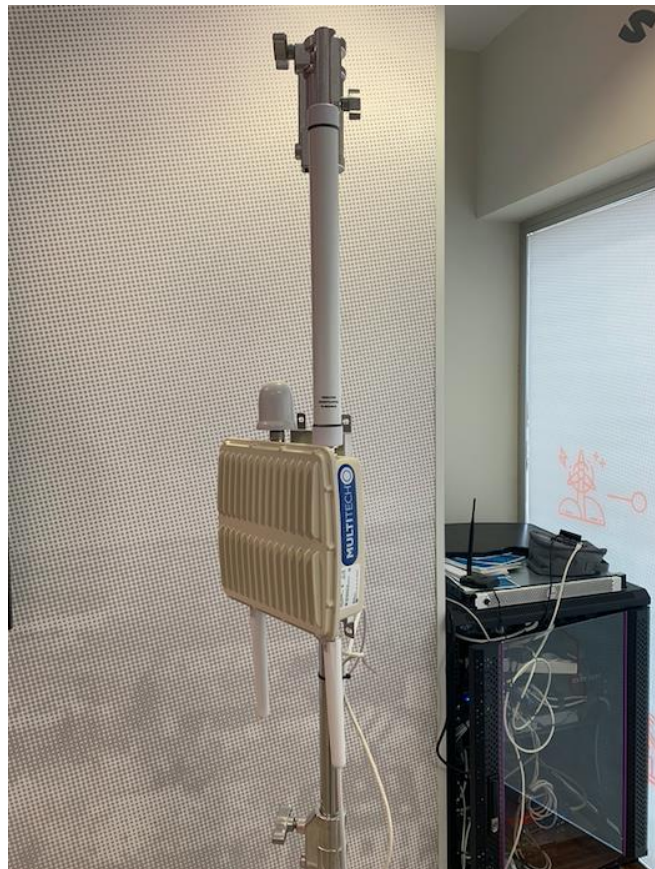
Figura 75. Gateway instalado en la sala Demo
