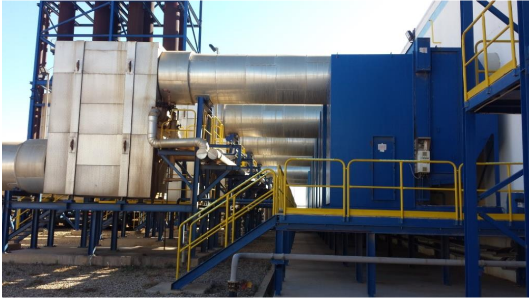
Figura 5. 36-Calderas de recuperación.
