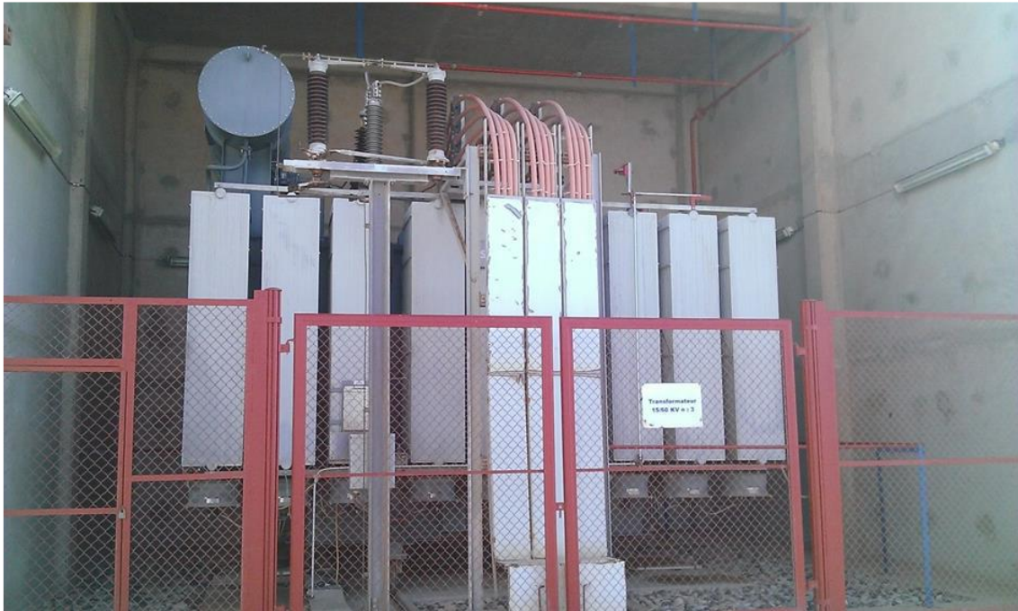
Figura 6. 2-Transformador de carga 400V/15KV.
