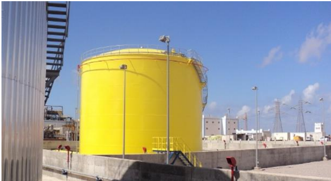
Figura 5. 2- Tanque de gasóleo de 5000 m3.
