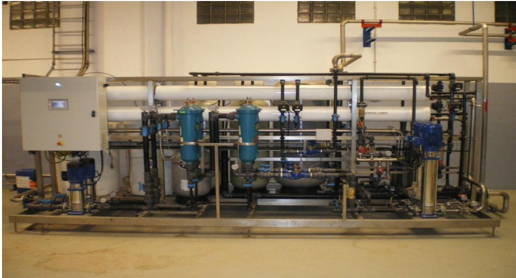
Figura 5. 25-Unidad de tratamiento de agua. propia.
