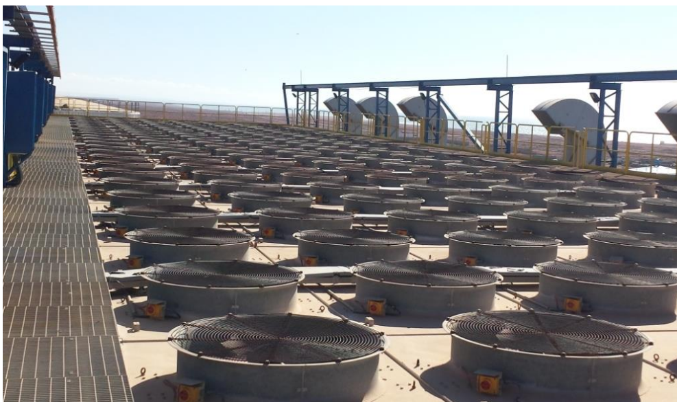
Figura 5. 17-Los radiadores de refrigeración.
