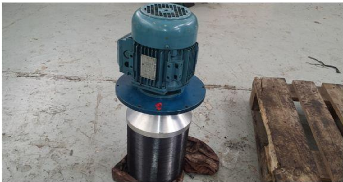
Figura 8. 24-Mantenimiento de motor de separador de aceite.
