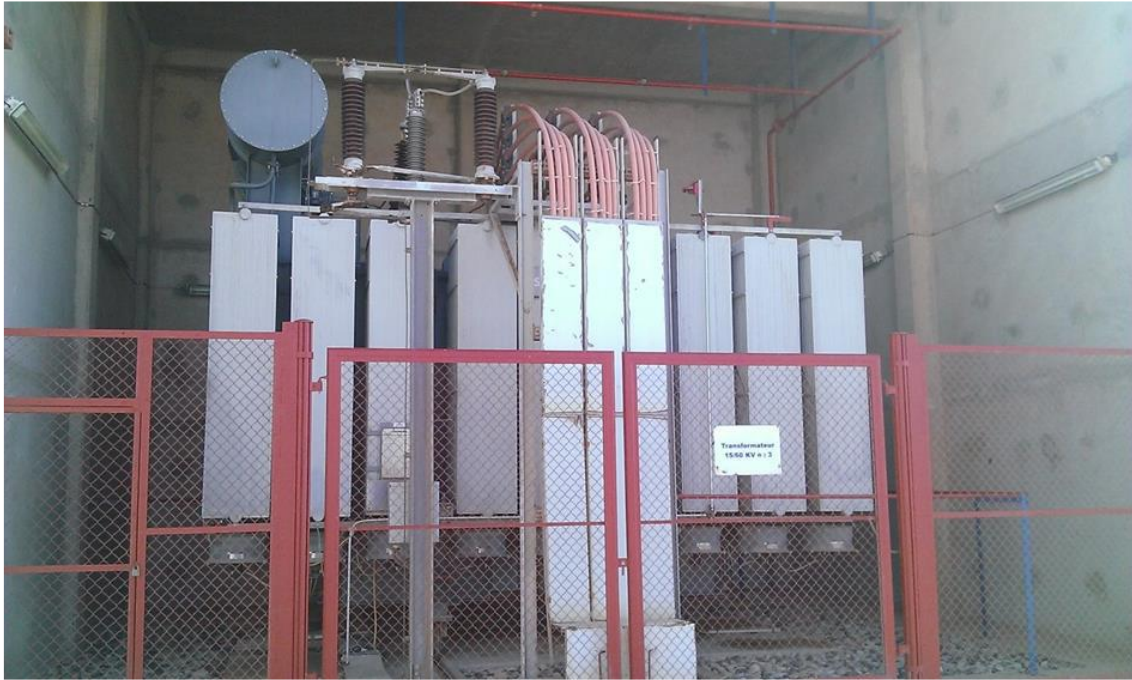
figura 4.7- Transformador auxiliar que alimenta los auxiliares de la central.
