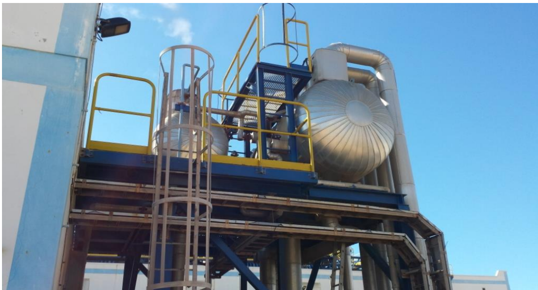
Figura 5. 39-Depósitos de vapor. propia.
