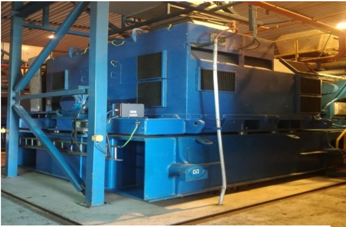
Figura 4.5- Generador Convertteam Ltd 15KV. Fuente propio.
