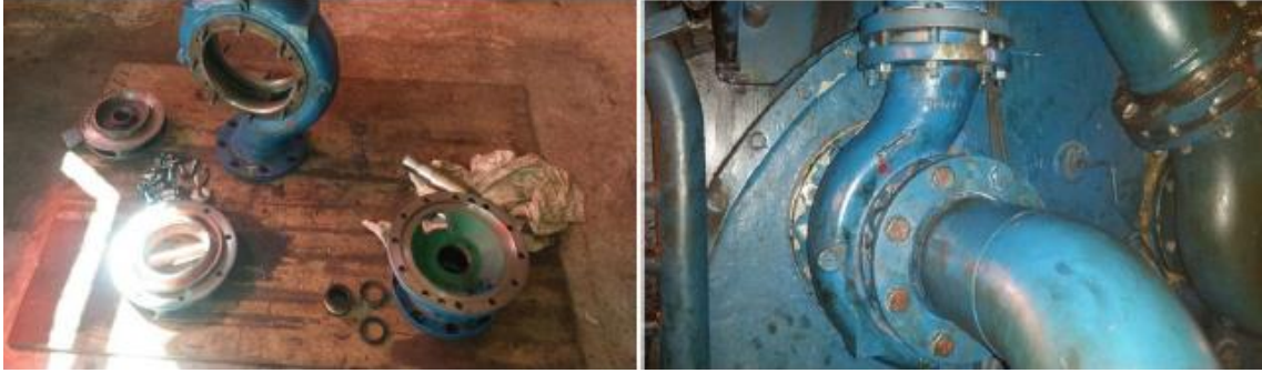
Figura 8. 15-Mantenimiento de bombas de agua de baja temperatura.
