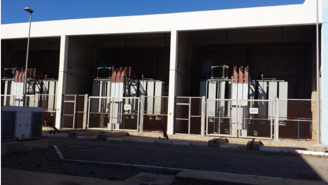
Figura 6. 1- Los transformadores elevadores (AT/MT). propia.
