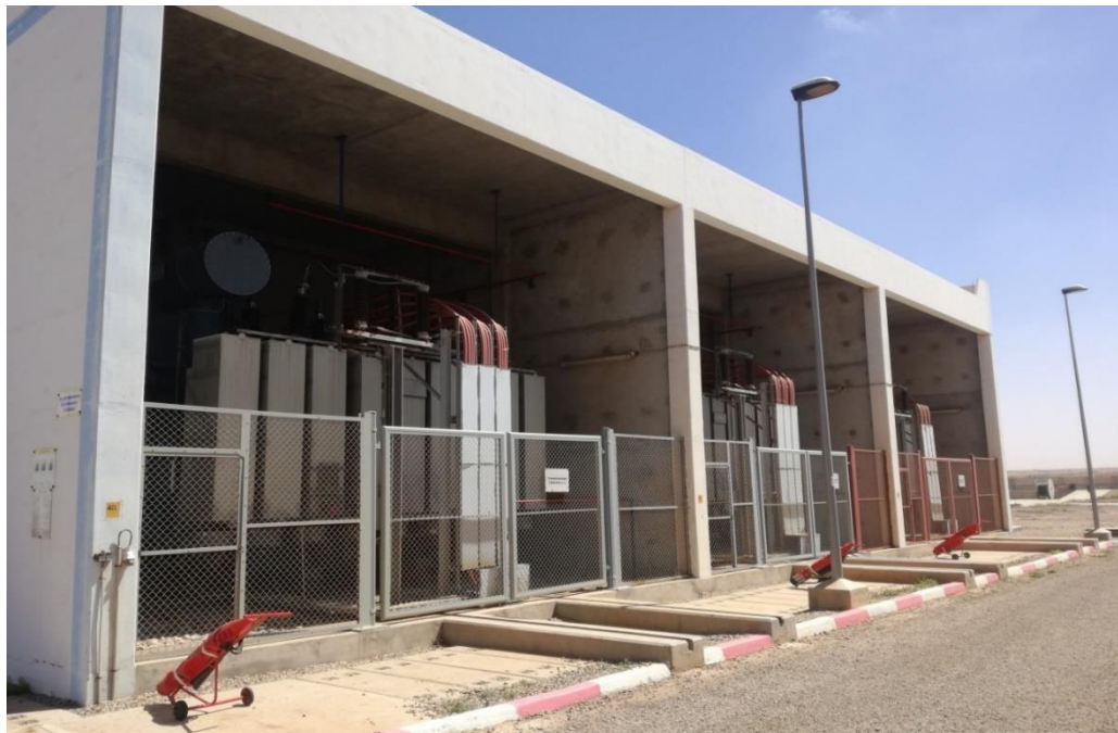
figura 4.6- los tres transformadores tipo siemens 15/60KV.
