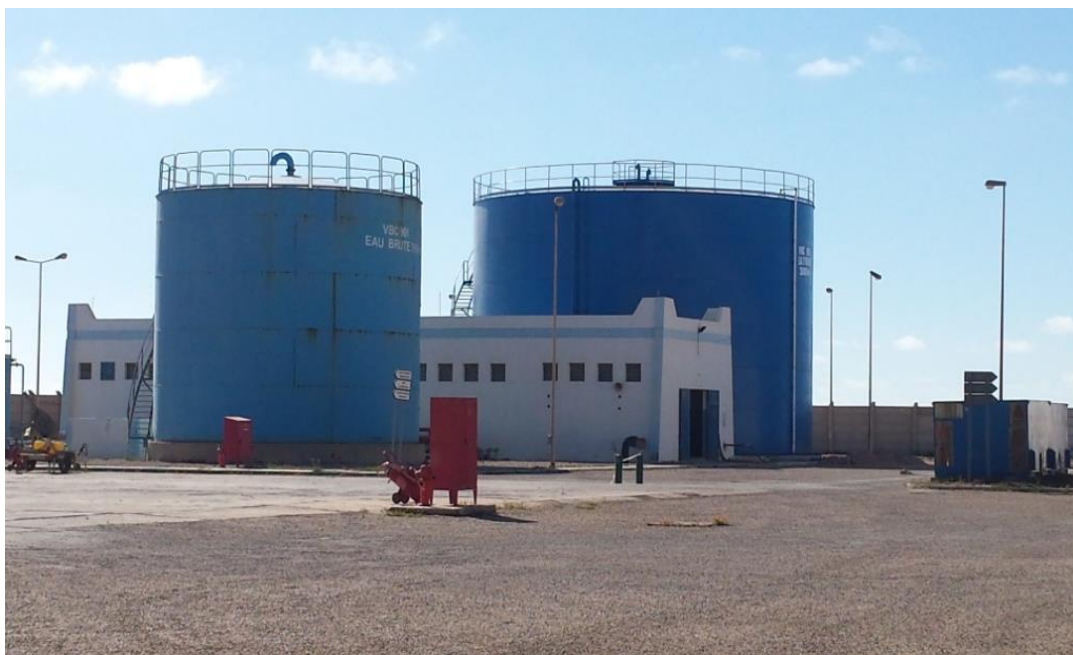
Figura 5. 22-Depósitos de agua bruta y de contra incendio. propia.
