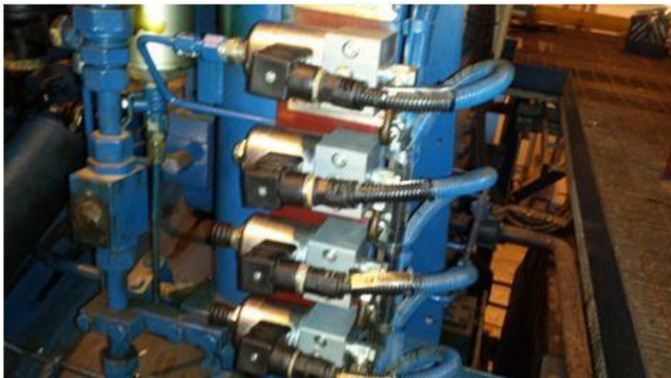
Figura 8. 28-Electroválvulas de aire 30 bar después del mantenimiento.
