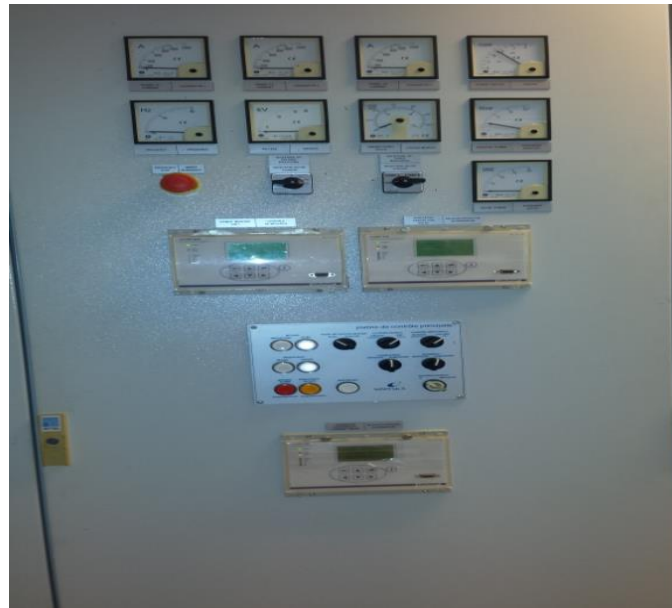
Figura 7. 6-Armario de comando de paradas de emergencia y otras funciones. propia.
