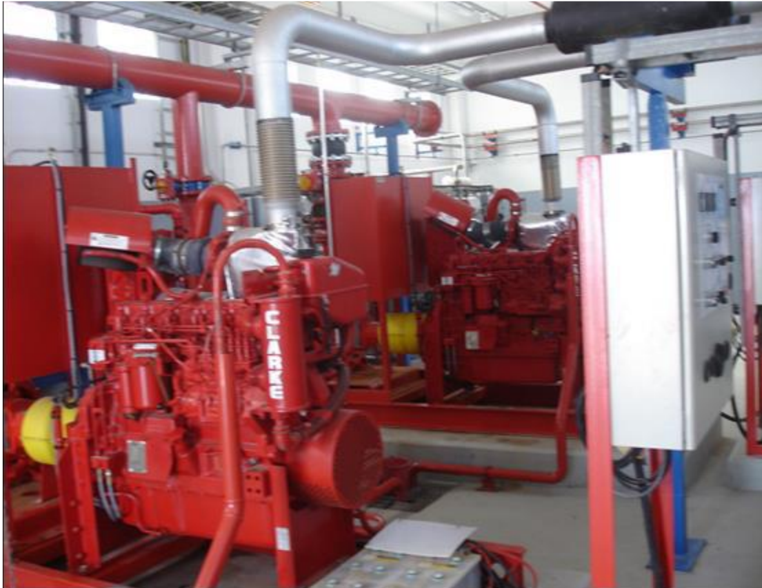
Figura 5. 29-Bombas Diésel contraincendios.
