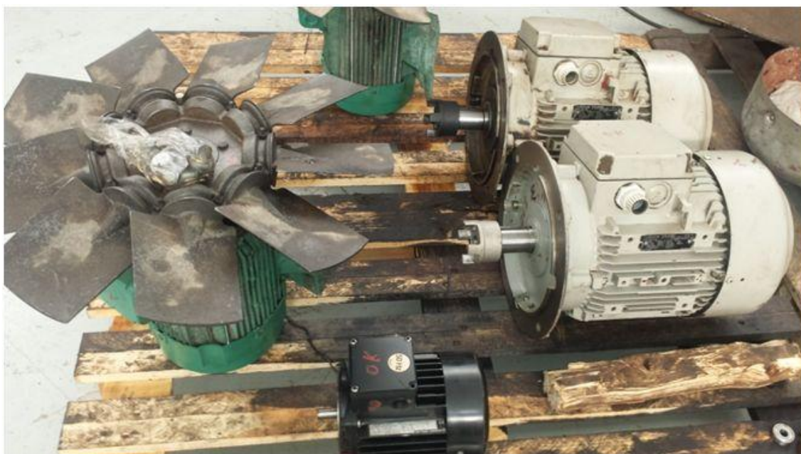
Figura 8. 25-Motores de ventilación.
