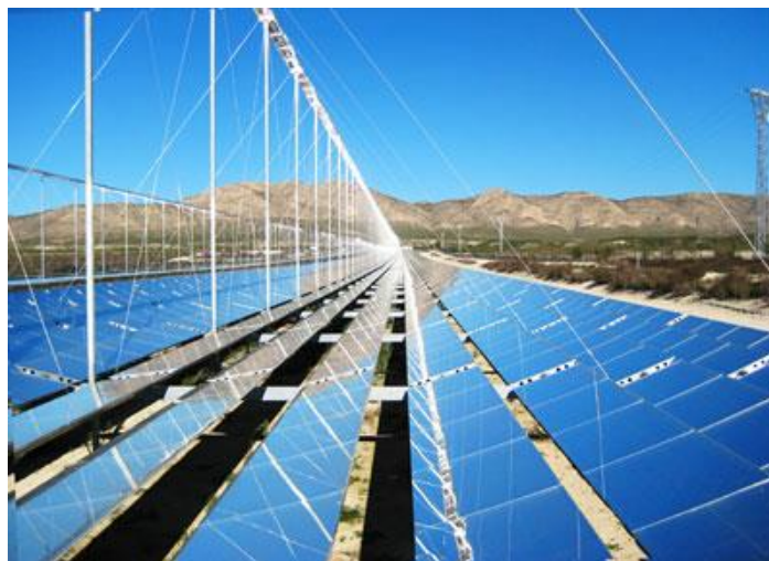
Figura 24. Central térmica solar con reflectores Fresnel
