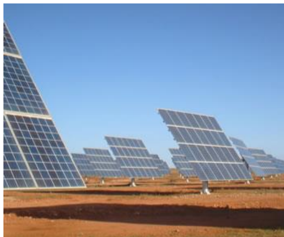
Figura 18. Planta solar de seguidores aislados
