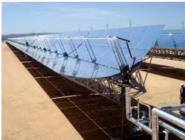
Figura 22. Central térmica solar con concentradores solares cilindro-parabólicos
