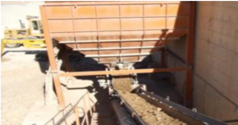
Figura 1.27. Descarga de la tolva a la cinta de alimentación de la criba.
