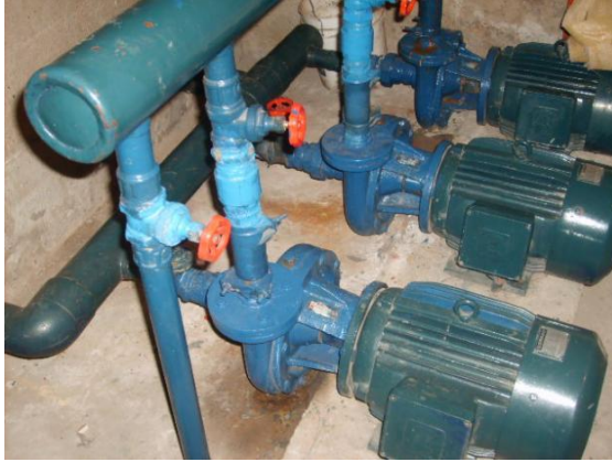
Bombas en bancada
