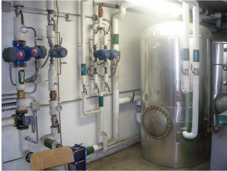
Depósito de inercia
