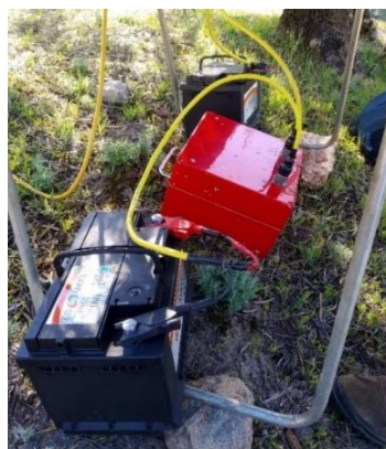
Figura 3. 7. Baterías y convertidor.
