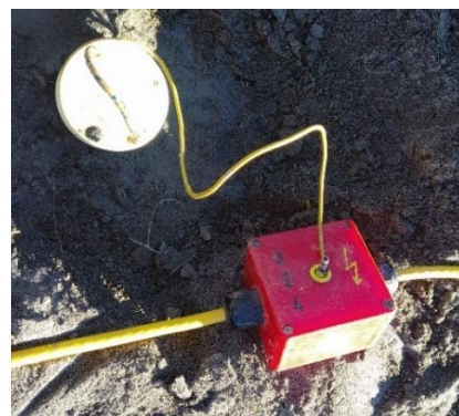
Figura 2. 15. Conexión del electrodo con el cable.
