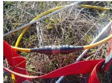
Figura 2. 14. Conexión entre familias de cables.
