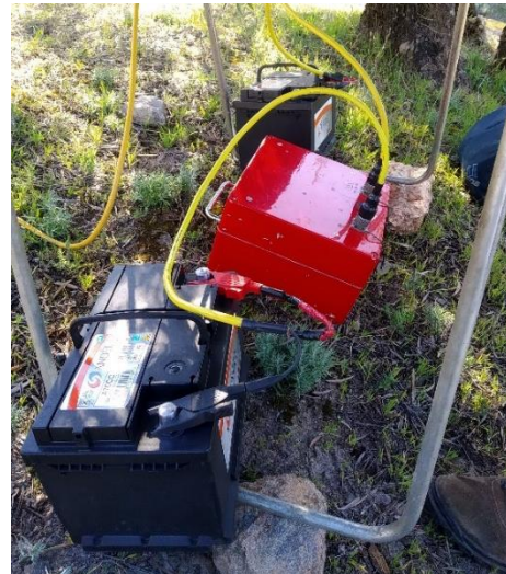
Figura 2. 17. Baterías y convertidor.
