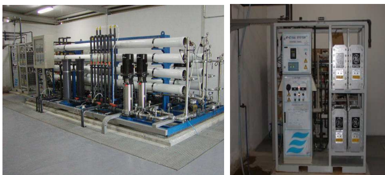
IMAGEN 9: Planta de Osmosis.
