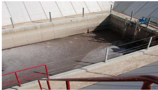
IMAGEN 10: Balsa de Efluentes.
