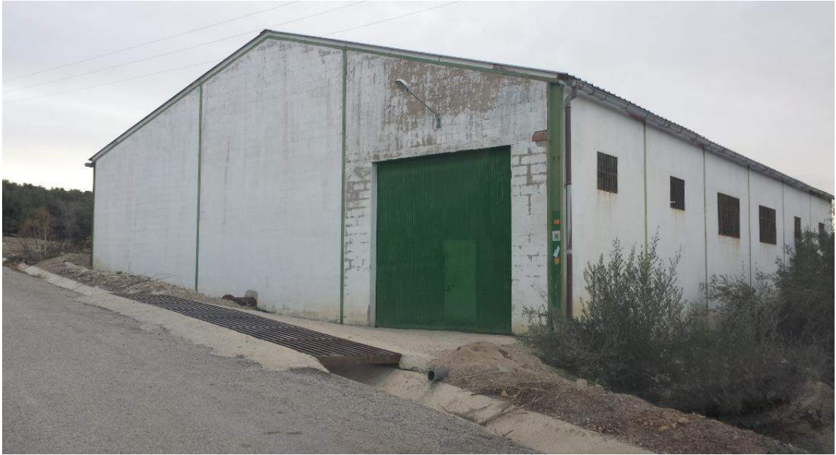
Ilustración 3. Nave filtrado, Afección Io2. P.K. 0+68
