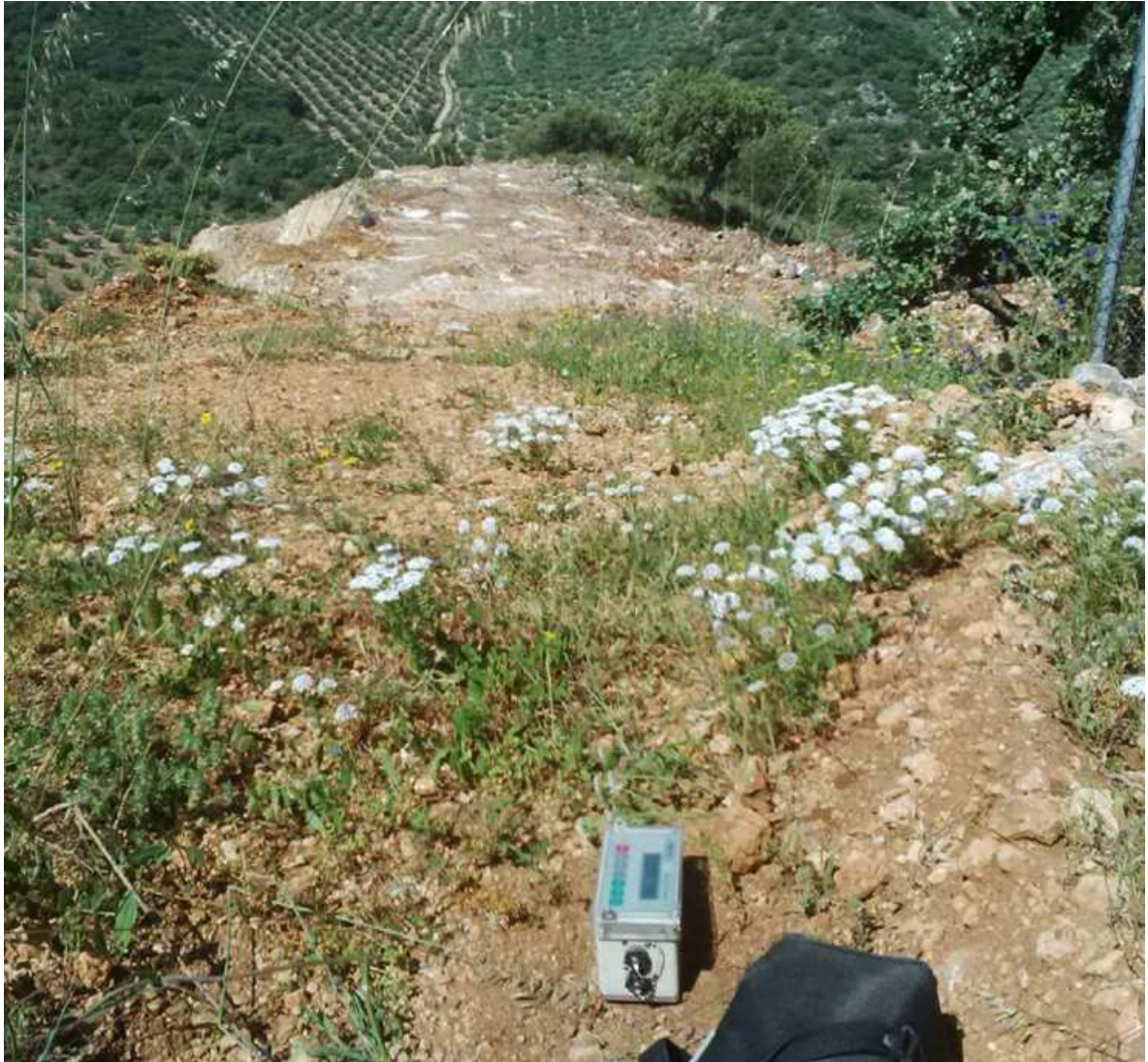
FIG 1.77. Sismógrafo, colocado en punto definido en la línea de voladura.
