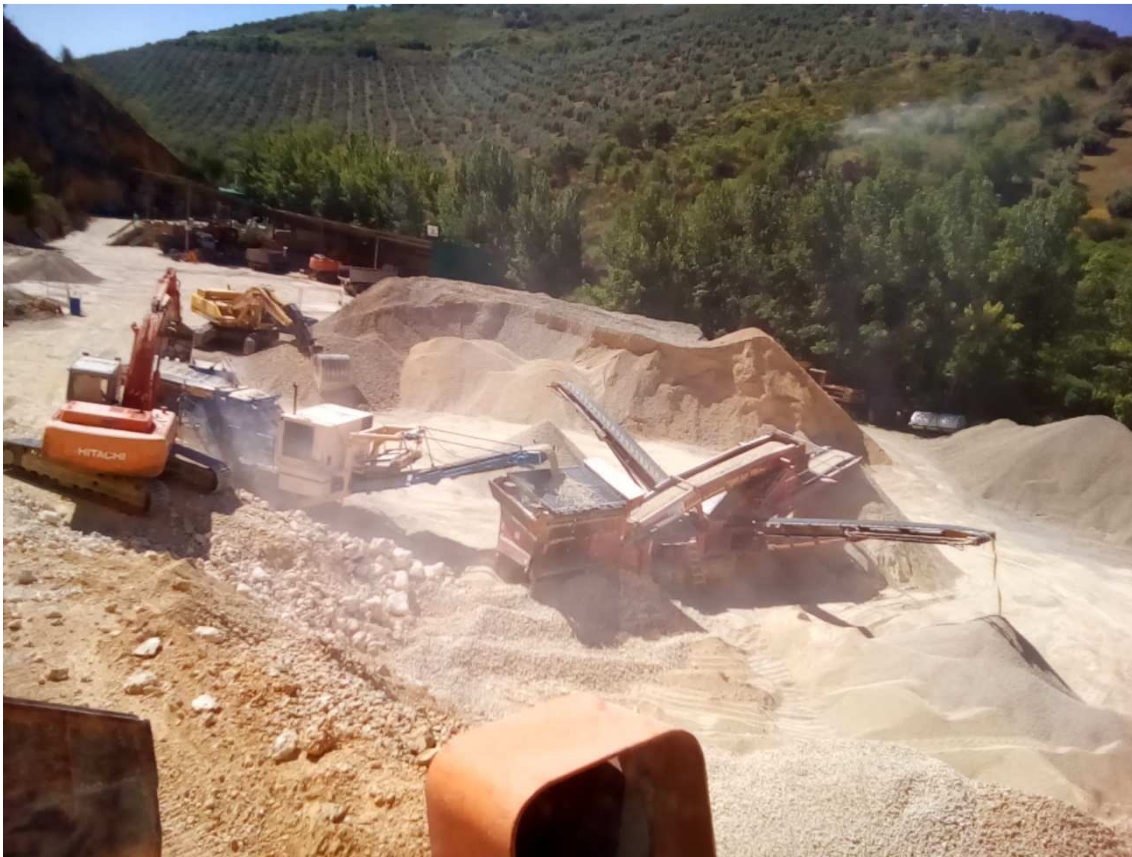
FIG 1.32 . Alimentación planta de molienda ( configuración molino- criba).
