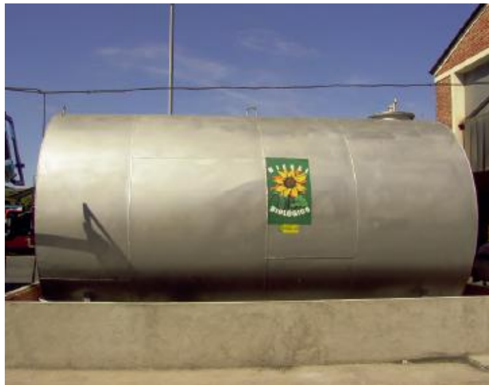
Ilustración 16. Ejemplo tanque de biodiesel. Fuente: Instituto para la Diversificación y Ahorro de Energía.
