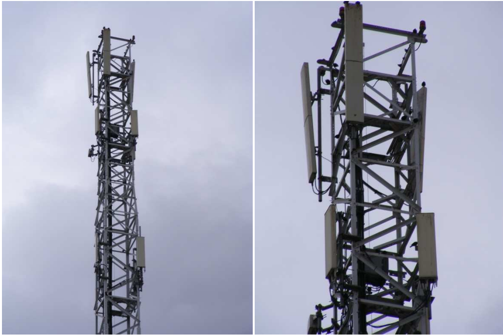
Imagen 2: Elementos radiantes de la estación base
