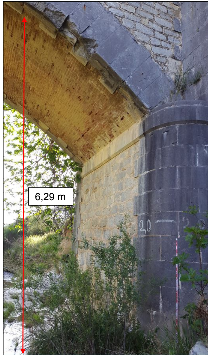
Figura 36. Evidencia 1: Daño en la estructura del puente Bajo situado a 6,29 metros sobre la superficie del cauce. Se incluye la referencia de la altura de 2 metros medida con un metro respecto al lateral del cauce.
