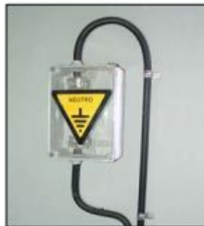
Figura 5. Caja de seccionamiento de servicio
