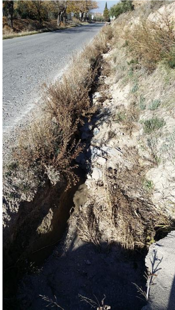
Figura nº 2 - Lateral de la carretera sin cuneta
