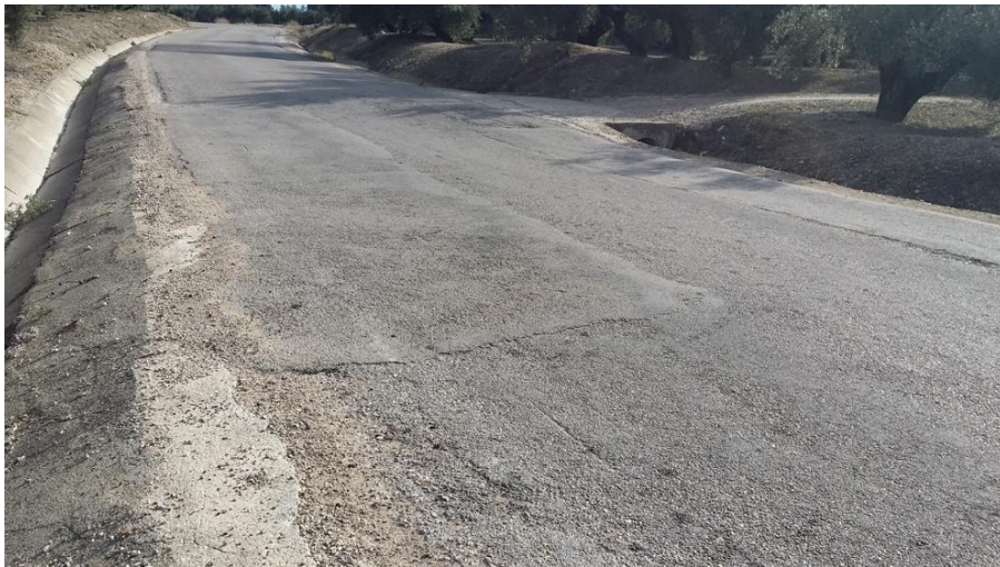
Figura nº 23 – Parcheado de la carretera y hundimiento
