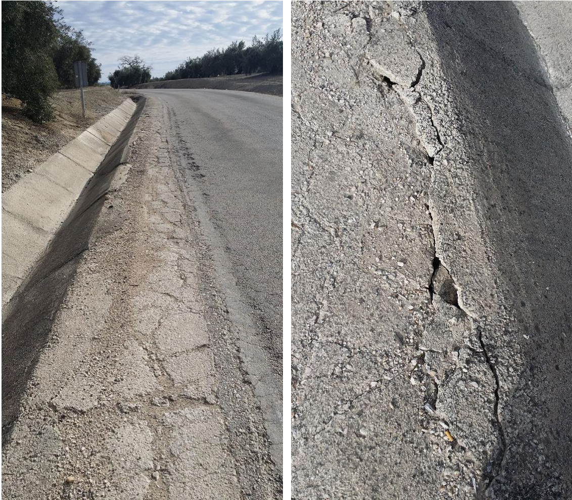
Figura nº 40 y 41 – Arcenes en mal estado de conservación
