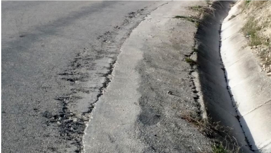
Figura nº 22 – Arcenes en mal estado de conservación
