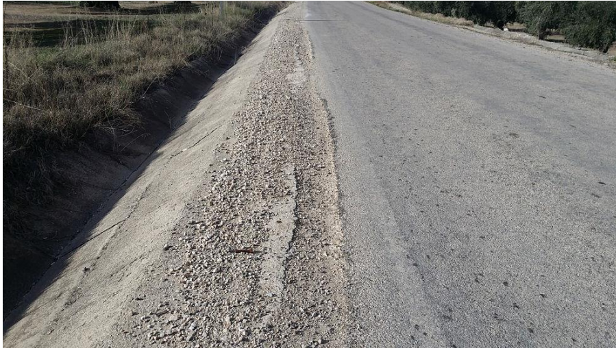
Figura nº 25 – Arcenes en mal estado de conservación
