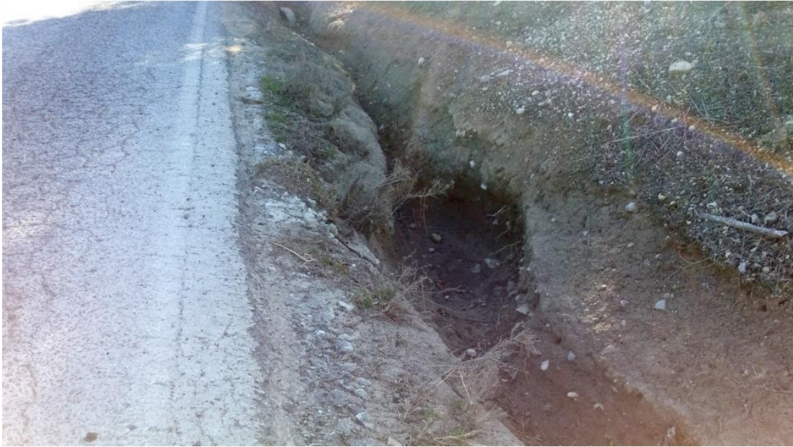
Figuran nº 7 – Margenes laterales dañados por las escorrentías
