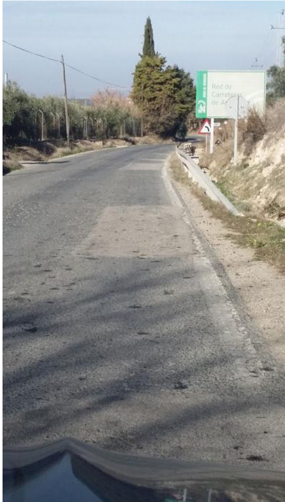
Figura nº 5 – Parcheados de la carretera
