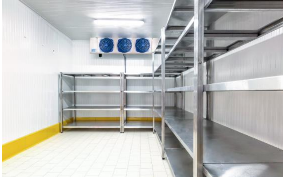
Ilustración 12. Cámara Frigorífica Industrial.
