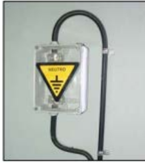
Figura 4. Caja de seccionamiento de servicio
