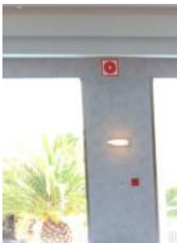
Imagen 17. Pulsadores de alarma y pictograma en uno de los salones. (Facilitado por la propiedad).
