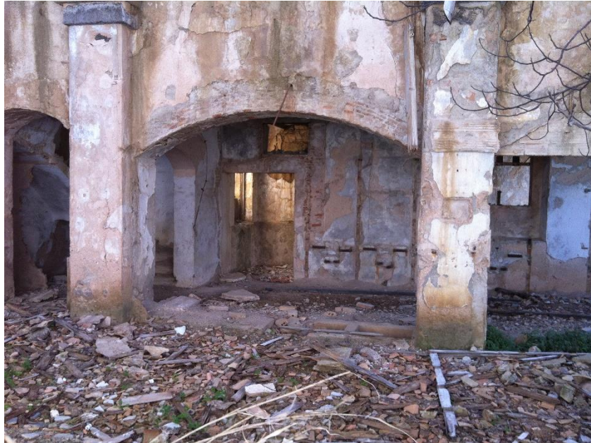
Ilustración 4.9. Dependencia de la sala donde se encontraba el centro de transformación
