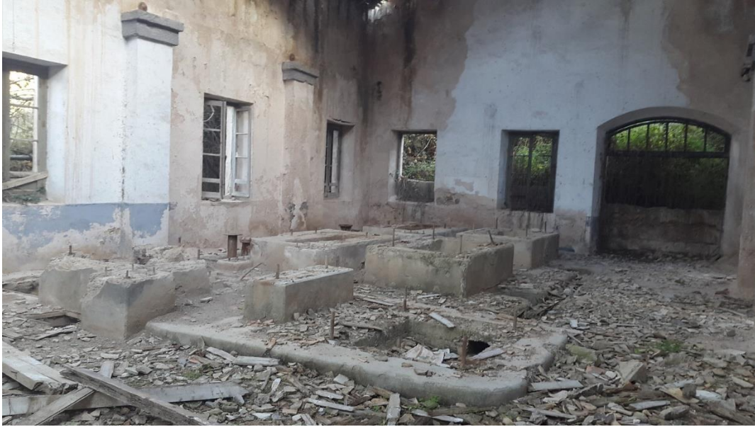
Ilustración 4.3. Sala de máquinas
