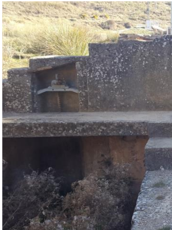
Ilustración 4.36. Compuerta de la toma
