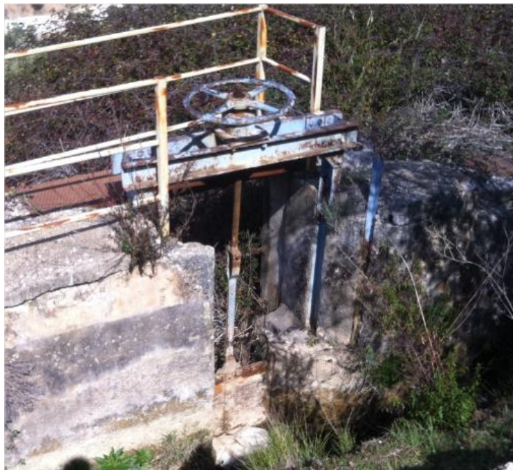
Ilustración 4.41. Compuerta de desagüe del canal de Castellón
