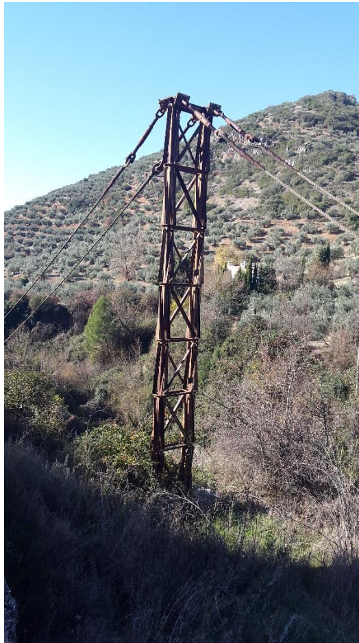
Ilustración 4.27. Apoyo de sujeción del tramo de tubería
