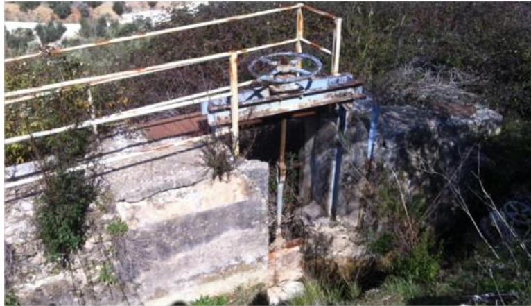
Ilustración 4.34. Canal de descarga
