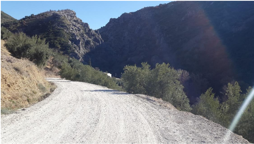
Ilustración 4.19. Carril sin asfaltar
