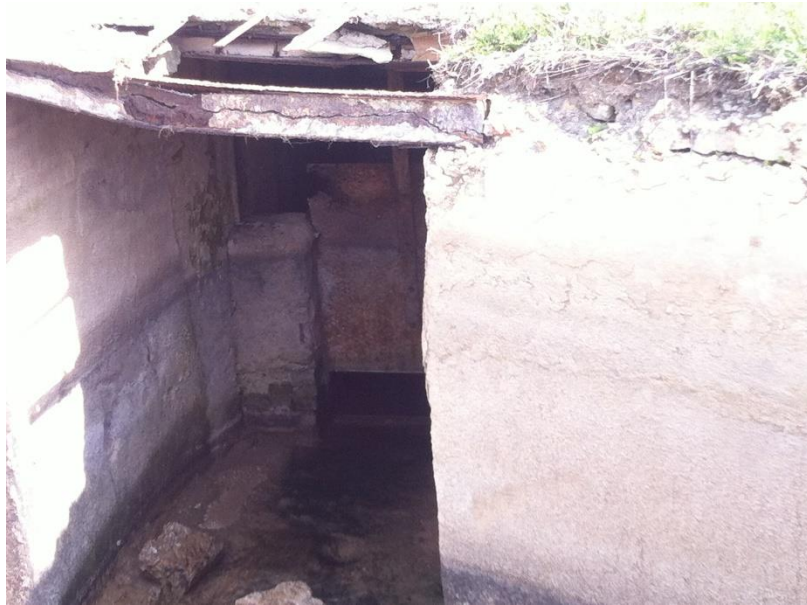
Ilustración 4.42. Compuerta de la cámara de carga
