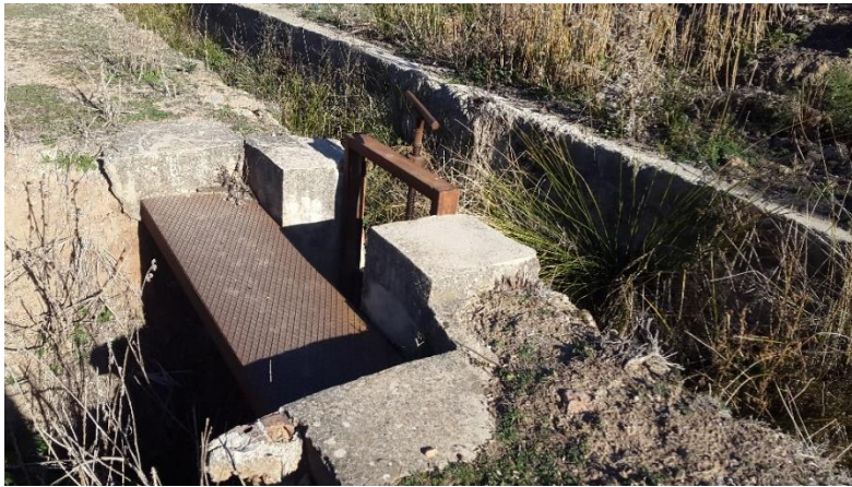
Ilustración 4.38. Compuerta de limitación de caudales
