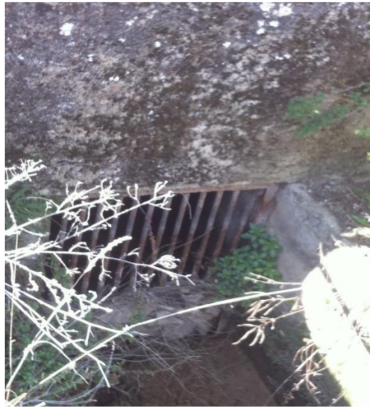
Ilustración 4.43. Rejilla entrada cámara de carga
