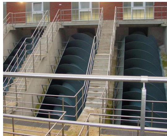
Figura 5.3: Bombas de tornillo de Arquímedes
