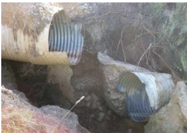
Figura 6: Rotura de una ODT debido al socavamiento provocado por la erosión en la embocadura (Lahiguera, Jaén). Fuente: Consejería de Fomento y Vivienda (2014).
