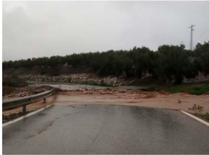
Figura 16: Inundaciones de la J-9007, diciembre 2019. Fuente: (https://lacontradejaen.com/temporal-lluvia-viento-jaen/)
