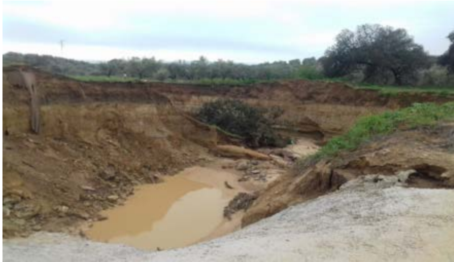
Figura 7: Tramo de la carretera JV-2312 colapsado a su paso por la finca Rentillas Bajas a la altura de una antigua ODT de aspecto similar a la de la figura 5 (foto J. Calero, mayo 2017).
