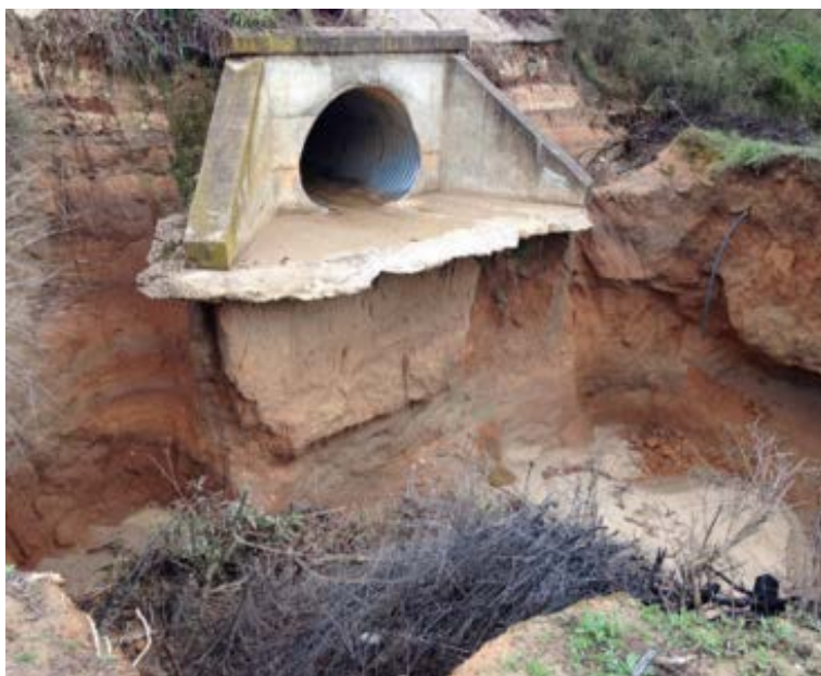
Figura 5: ODT en el km. 4 de la carretera JV-2312 (finca Rentillas Bajas) a punto de colapsar por la erosión de su embocadura (foto J. Calero, marzo 2018).
