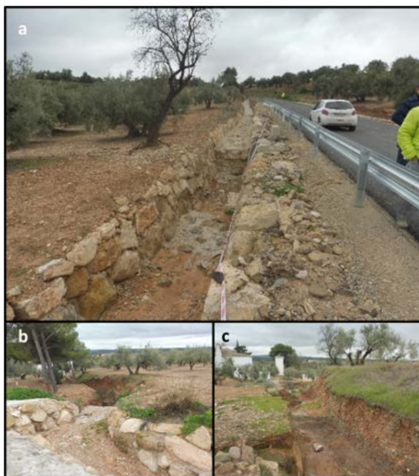
Figura 18: Zona de estudio 2. a) Nuevo tramo de cuneta construido en el margen izquierdo de la carretera; b) Desagüe de la cuneta sobre el olivar adyacente; c) cárcava generada por el drenaje de la cuneta.
