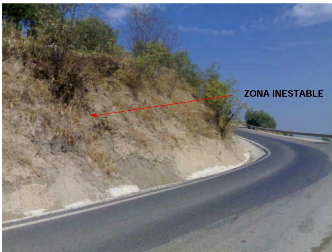
Figura 12. Talud excavado en la formación de arcillas versicolores, se pueden observar algunas inestabilidades locales en fácies más arcillosas.
