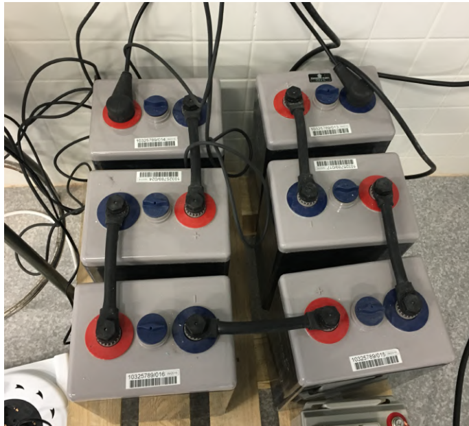
Figura 4.7 – Tipo de batería utilizada en el banco de baterías. Fuente propia.
