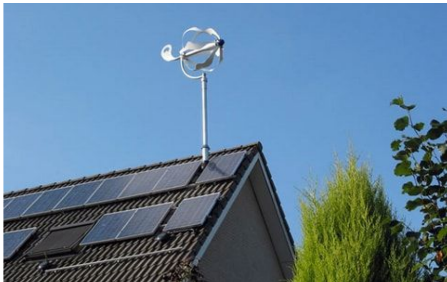
Figura 2.16. – Instalación domestica eólica. Fuente [11]
