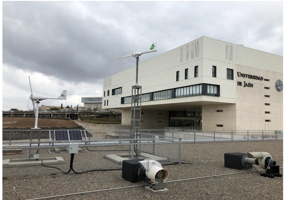
Figura 4.21 – Aerogenerador en EPSL. Fuente propia.
