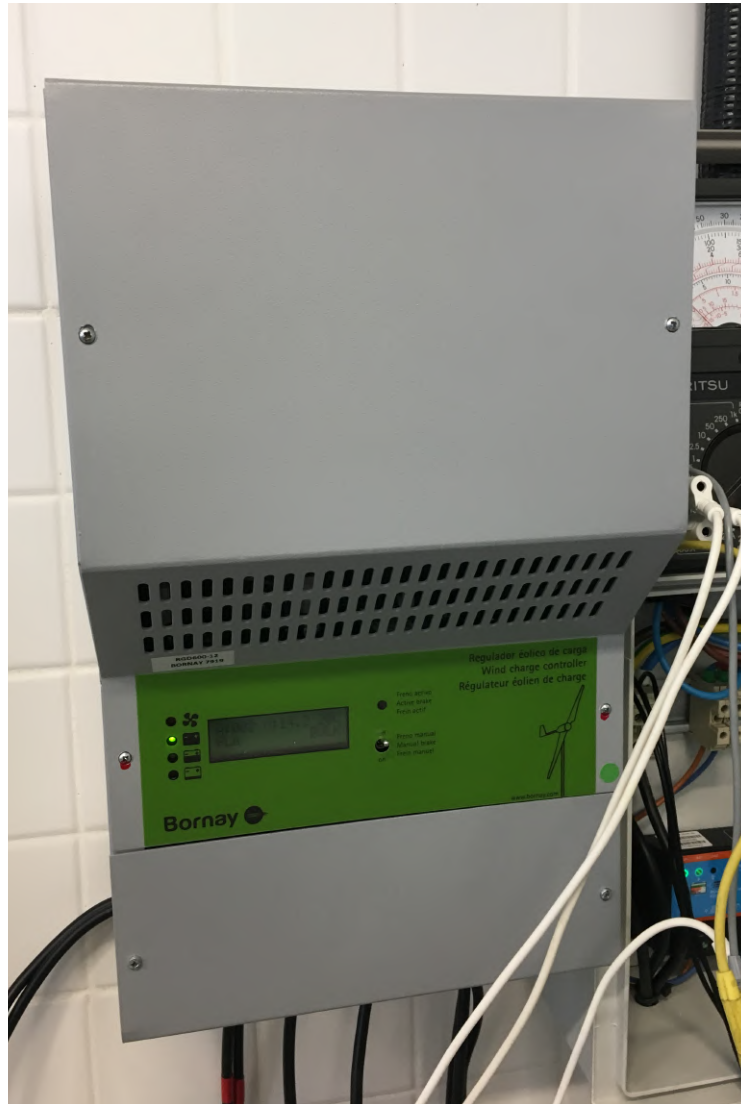
Figura 4.6 – Regulador / Inversor fijado en pared. Fuente propia.
