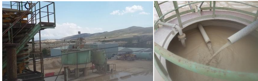
Fotos 32 y 33: Tanque espesador
