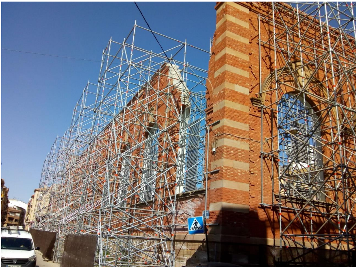
Imagen 5: Estado actual fachada trasera y lateral NO.
