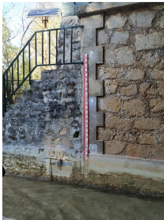
Ilustración 23 Aforador por altura en Central Cerrada del Utrero (Elaboración propia)
