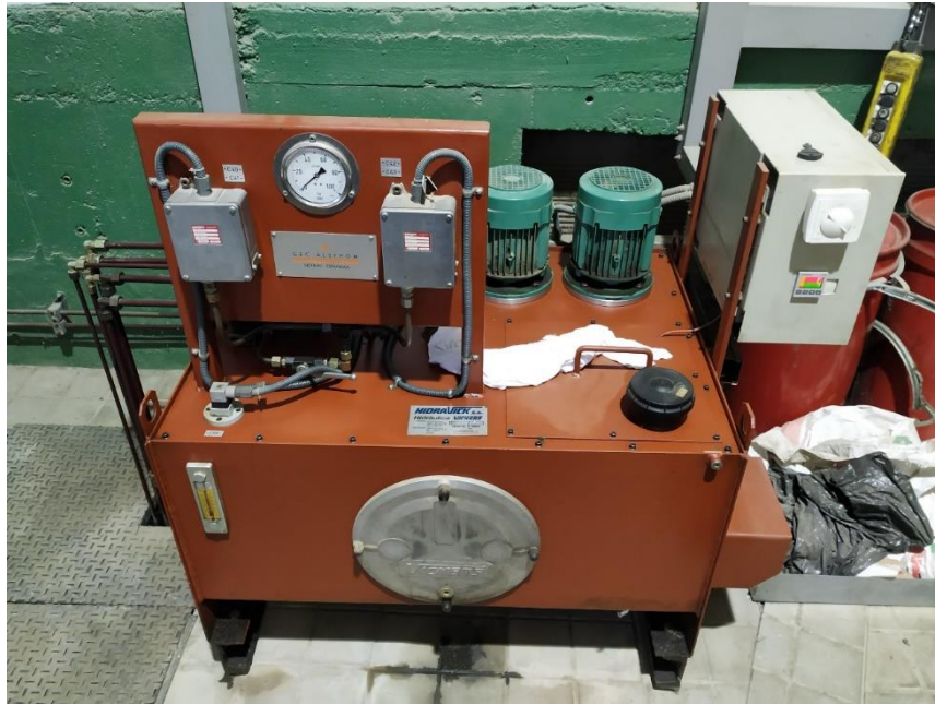
Ilustración 16 Sistema de regulación hidráulica en Central Pantano Cubillas (Elaboración propia)
