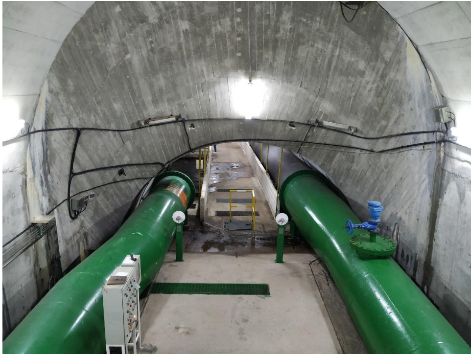
Ilustración 22 Tubería forzada con ventosas en Presa del río Yeguas (Elaboración propia)
