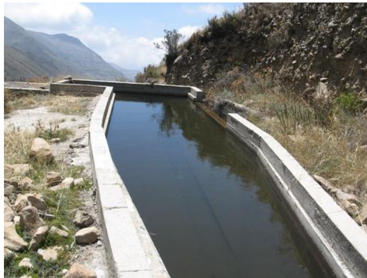
Ilustración 8 Cámara de carga
