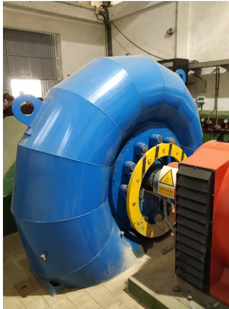
Ilustración 14 Turbina Francis en Central Pantano Cubillas (Elaboración propia)
