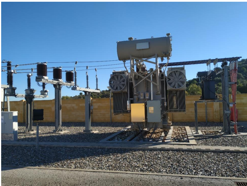
Ilustración 17 Transformador elevador exterior (Elaboración propia)
