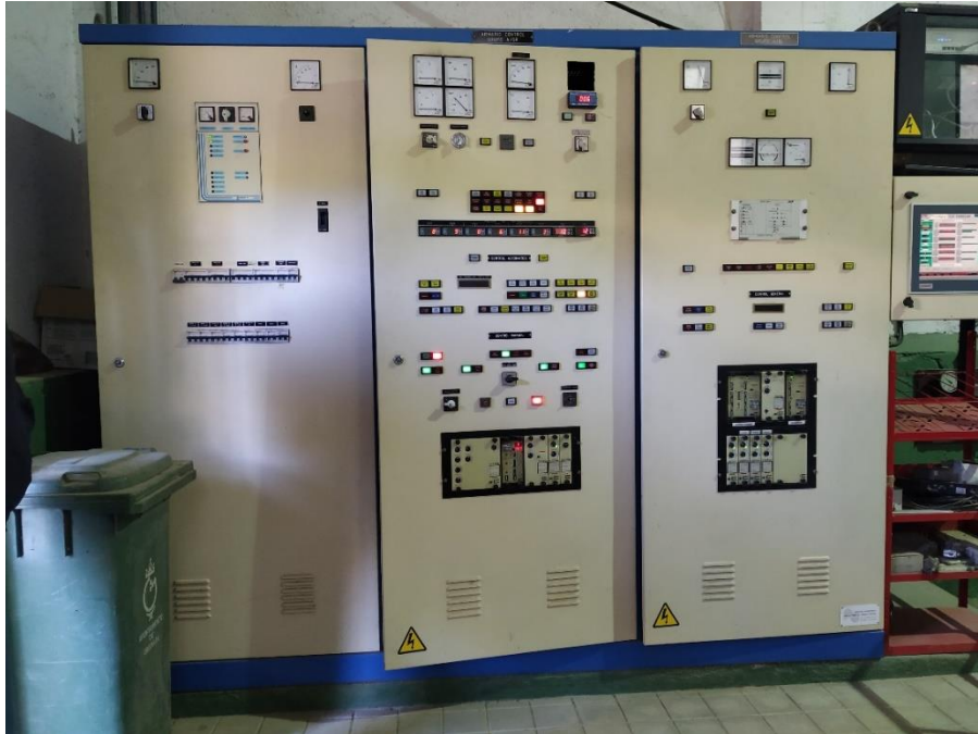
Ilustración 18 Cuadro eléctrico Central Pantano Cubillas (Elaboración propia)
