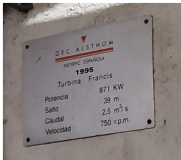
Ilustración 49 Características turbina Francis central Pantano Cubillas (Elaboración propia)
