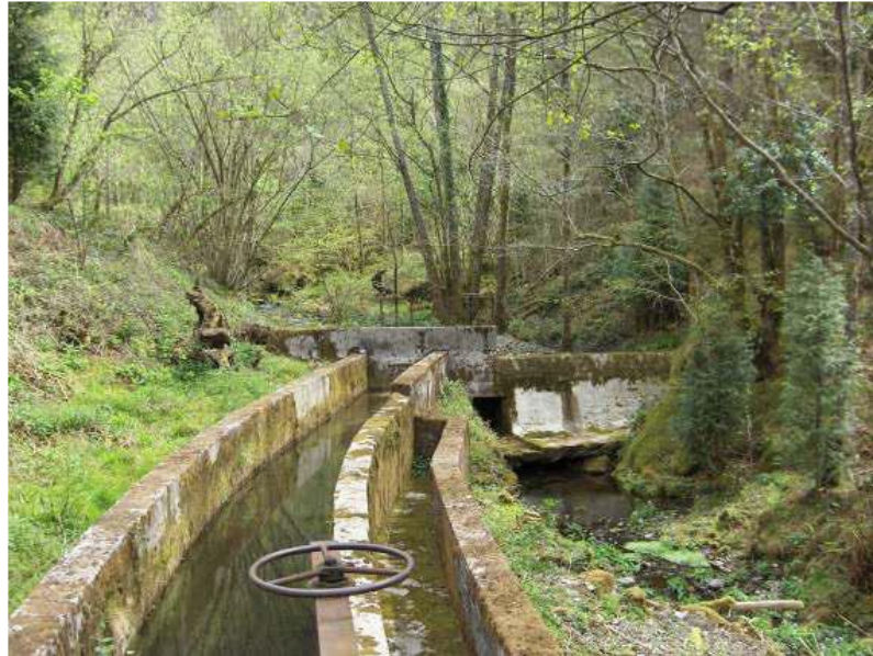
Ilustración 6 Canal e infraestructura en arroyo Santolas
