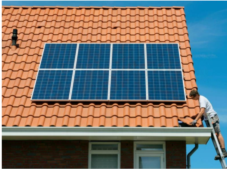
Figura 8-Instalación Fotovoltaica sobre el tejado
