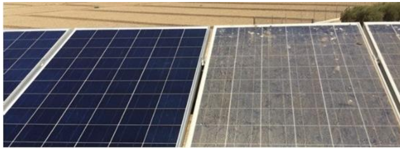
Figura 15-Panel fotovoltaica con suciedad
