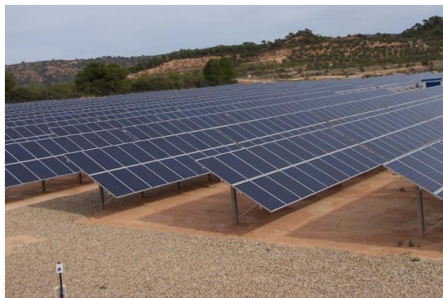
Figura 9-Instalación Fotovoltaica sobre el terreno
