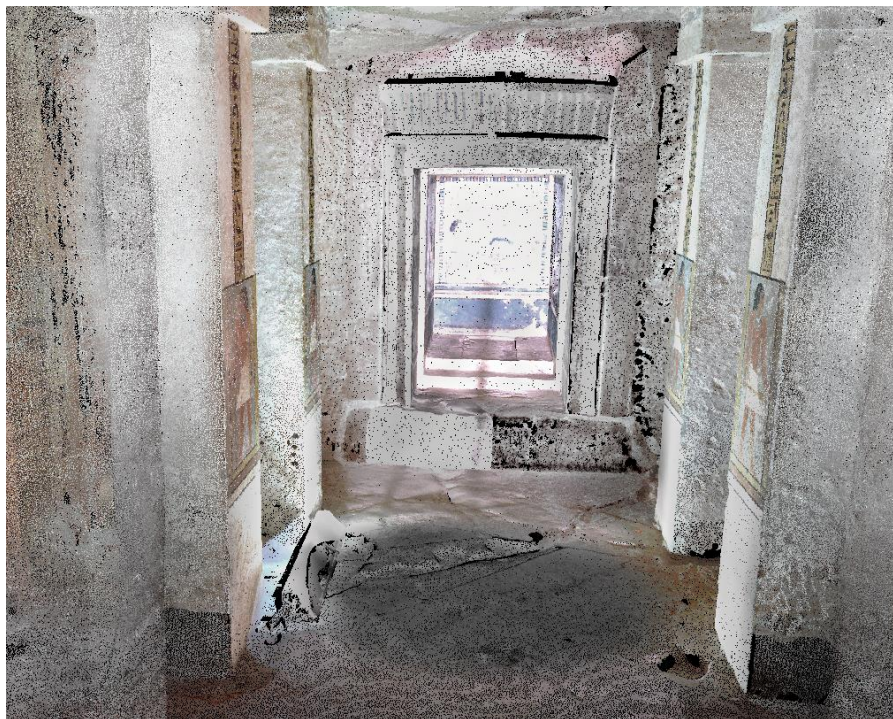
Figura 54. Falta de RGB y huecos en la cripta.
