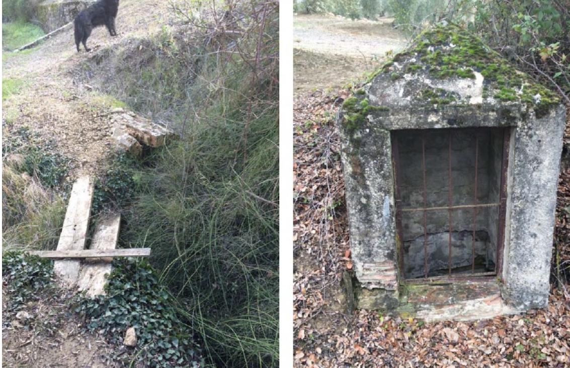
Imagen 2.4.20. Canal. Chimenea acceso de mantenimiento del canal. Fuente: Estudio de viabilidad de minicentrales provincia de Jaén. AGENER-Universidad de Jaén
