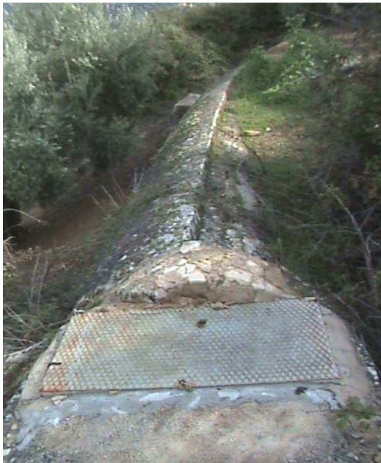
Imagen 2.4.23. Canal. Cubierta original y zona de cubierta reparada por Aqualia. Fuente: Estudio de viabilidad de minicentrales provincia de Jaén. AGENER-Universidad de Jaén
