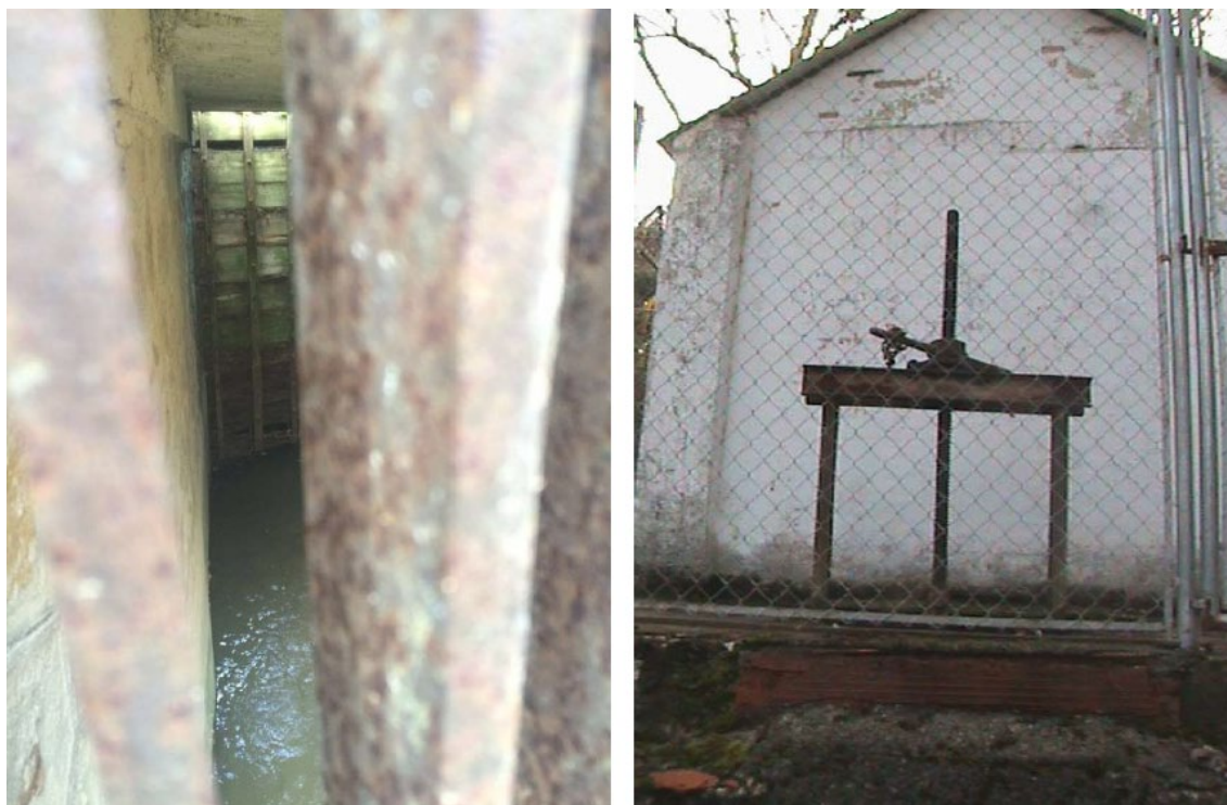
Imagen 2.4.39. Compuertas de entrada al canal. Fuente: Estudio de viabilidad de minicentrales provincia de Jaén. AGENER-Universidad de Jaén
