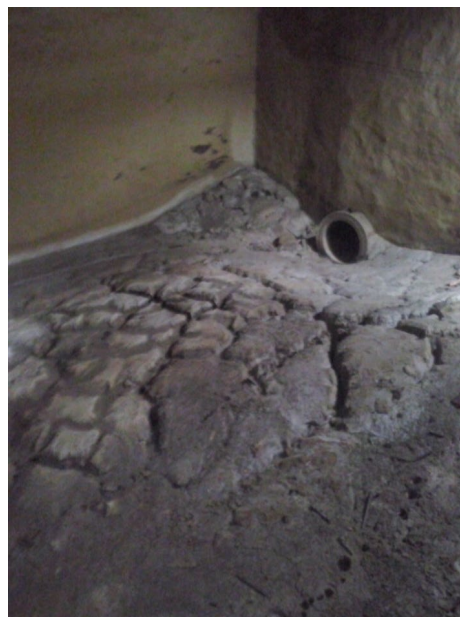
Imagen 2.4.32. Cámara de carga, Interior cámara de carga, inicio tubería forzada. Fuente: Estudio de viabilidad de minicentrales provincia de Jaén. AGENER-Universidad de Jaén
