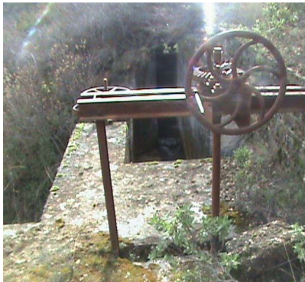
Imagen 2.4.42. Compuerta. Mecanismo de compuerta de entrada a cámara. Fuente: Estudio de viabilidad de minicentrales provincia de Jaén. AGENER-Universidad de Jaén
