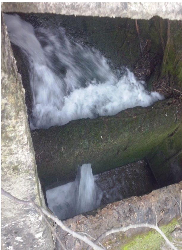
Imagen 2.4.53. Desagüe de la central. Desembocadura del canal aliviadero en el desagüe de la central, inicio del canal. Fuente: Estudio de viabilidad de minicentrales provincia de Jaén. AGENER-Universidad de Jaén
