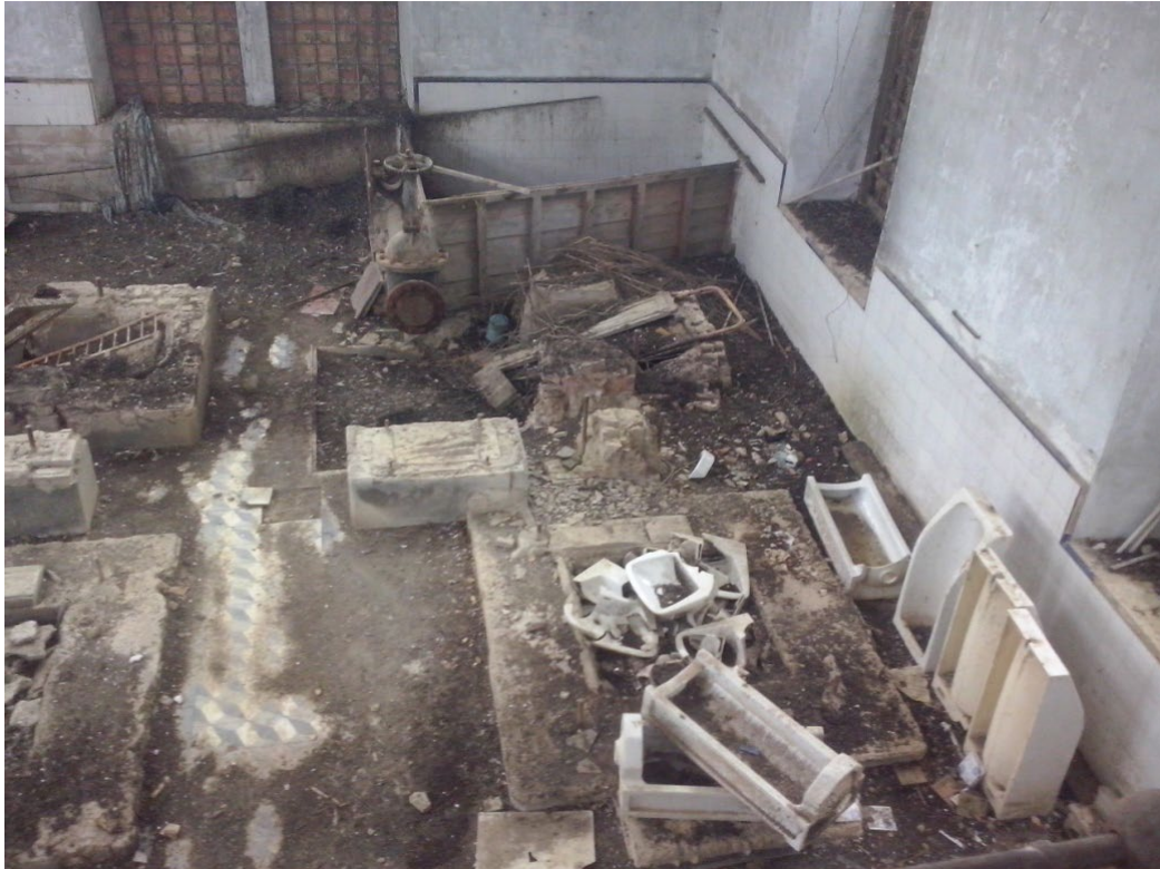
Imagen 2.4.3. Sala de máquinas. Fuente: Estudio de viabilidad de minicentrales provincia de Jaén. AGENER-Universidad de Jaén
