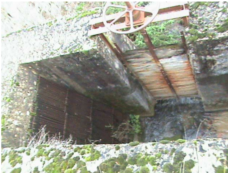
Imagen 2.4.29. Canal, compuerta de desagüe. Fuente: Estudio de viabilidad de minicentrales provincia de Jaén. AGENER-Universidad de Jaén
