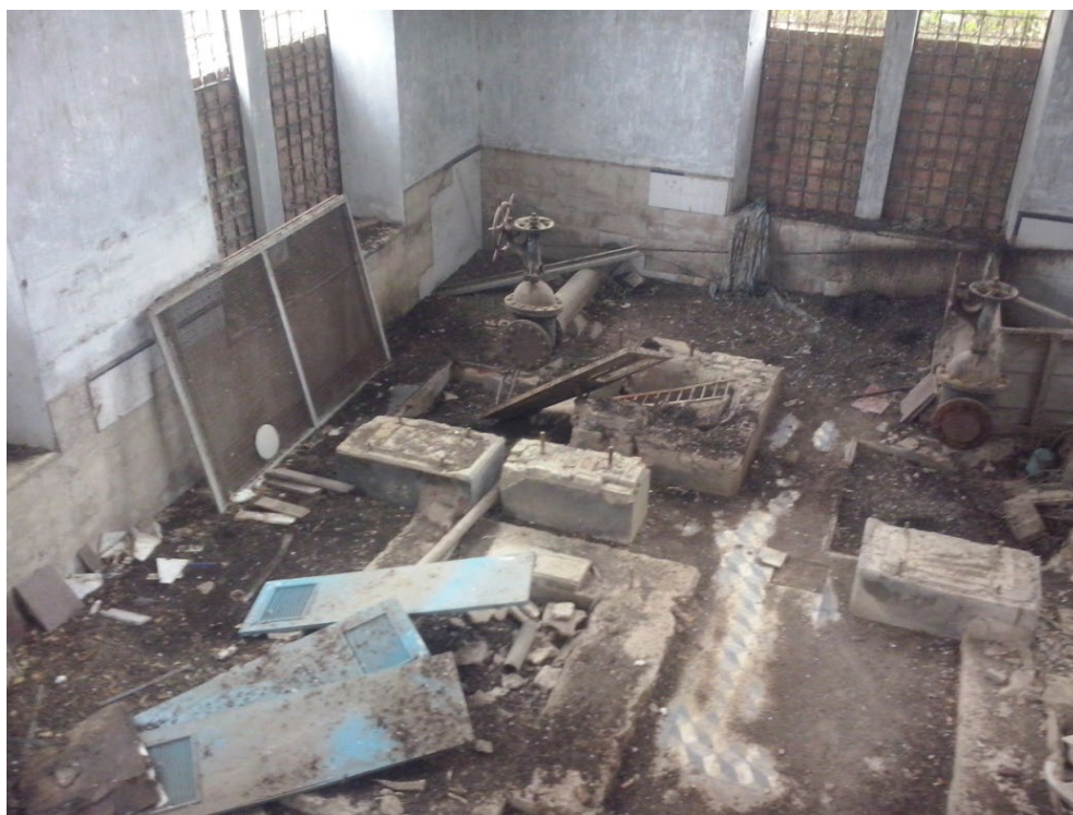
Imagen 2.4.2. Sala de máquinas. Fuente: Estudio de viabilidad de minicentrales provincia de Jaén. AGENER-Universidad de Jaén
