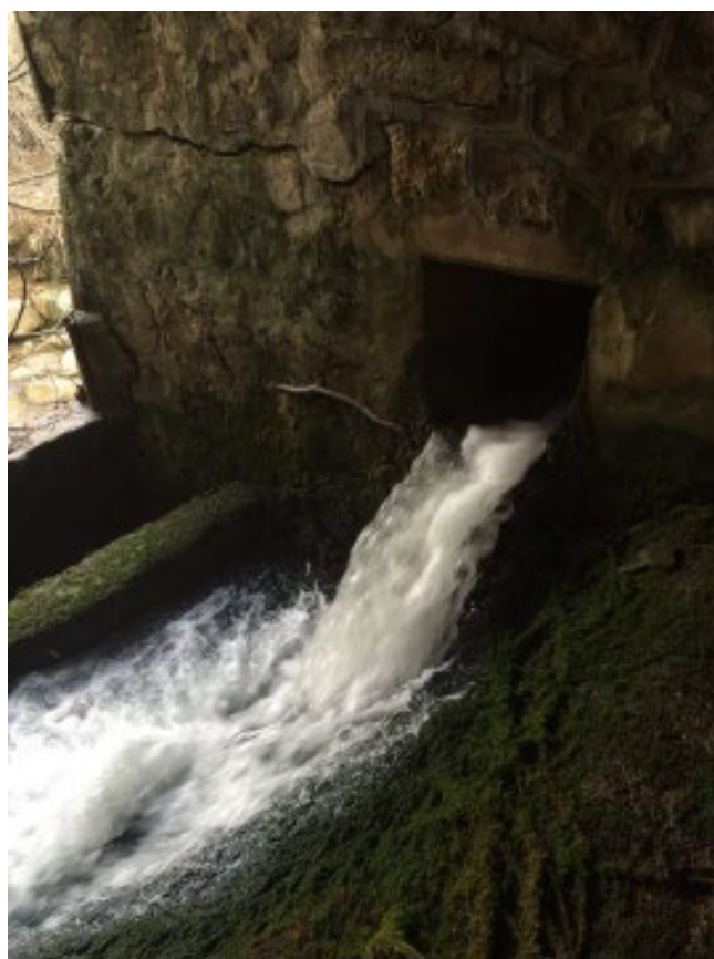
Imagen 2.4.49. Canal aliviadero. Desembocadura del canal aliviadero en el desagüe de la central. Fuente: Estudio de viabilidad de minicentrales provincia de Jaén. AGENER-Universidad de Jaén
