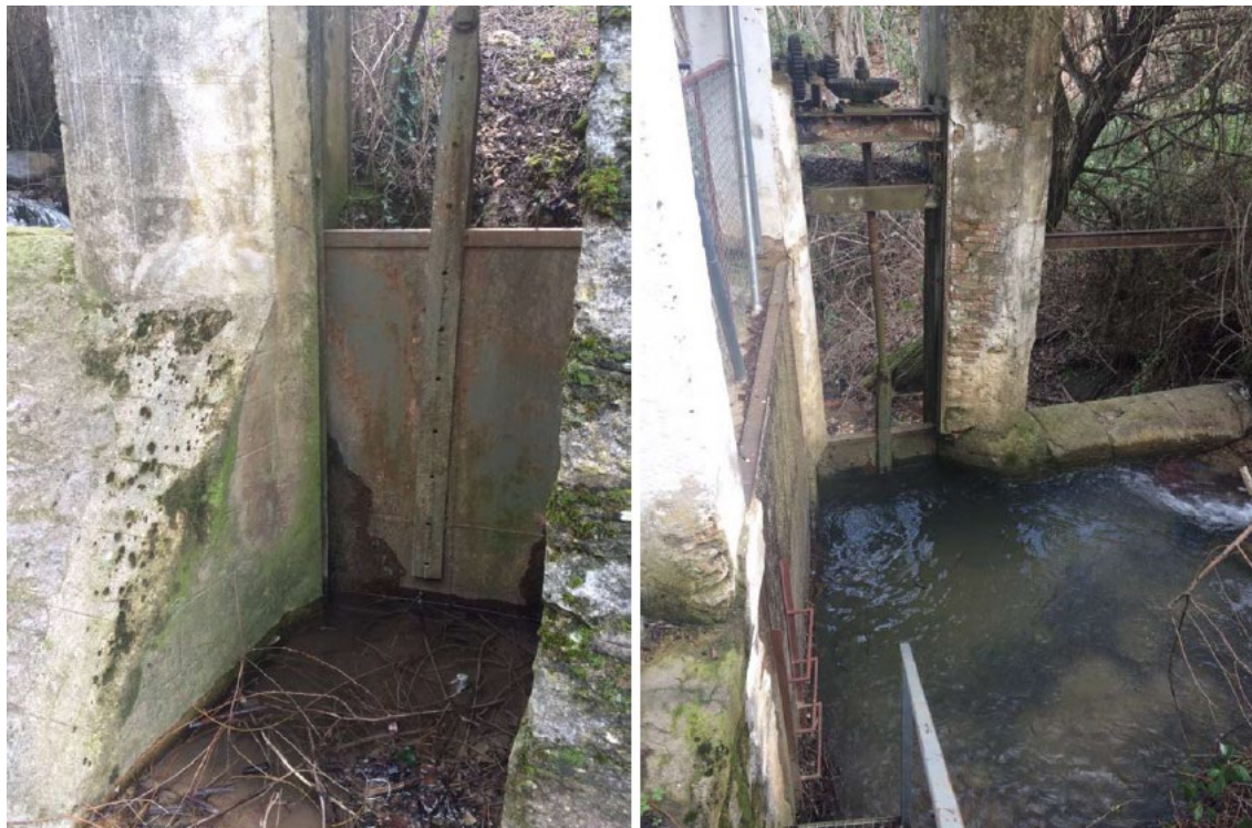
Imagen 2.4.38. Compuertas del azud. Fuente: Estudio de viabilidad de minicentrales provincia de Jaén. AGENER-Universidad de Jaén
