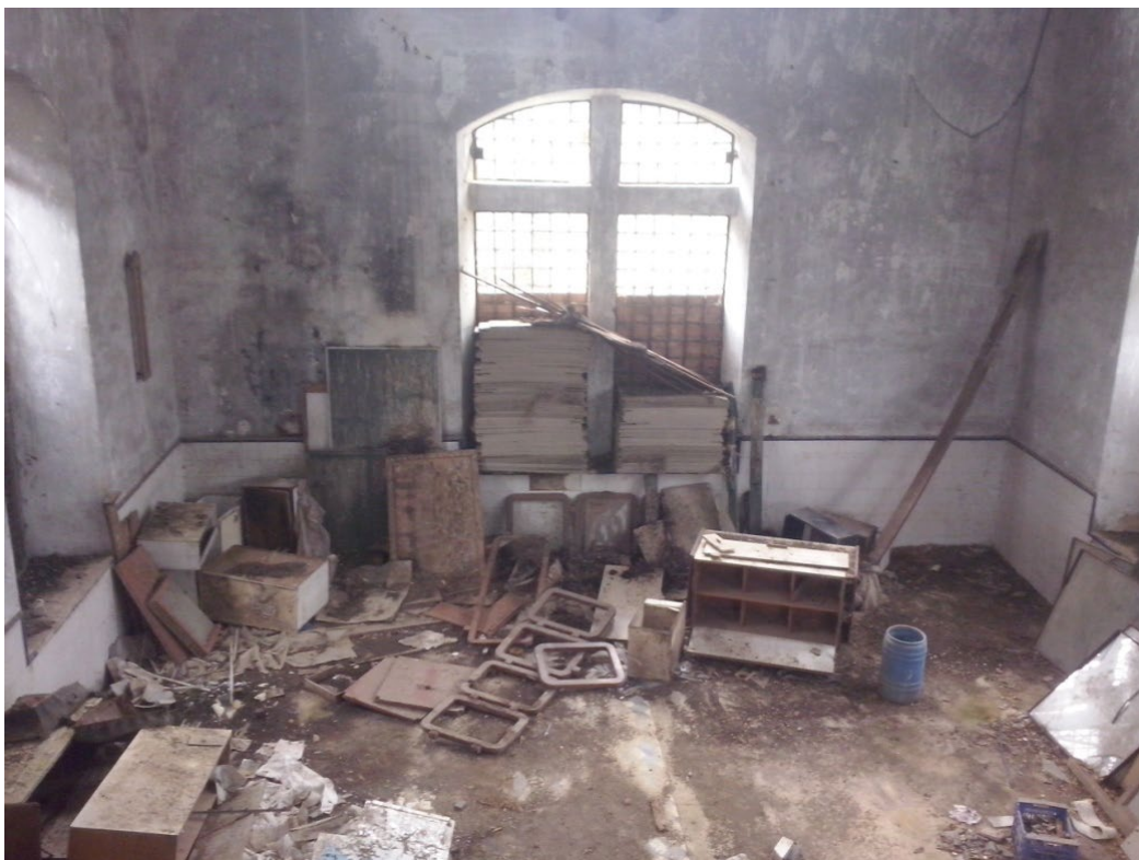
Imagen 2.4.4. Sala de máquinas. Fuente: Estudio de viabilidad de minicentrales provincia de Jaén. AGENER-Universidad de Jaén
