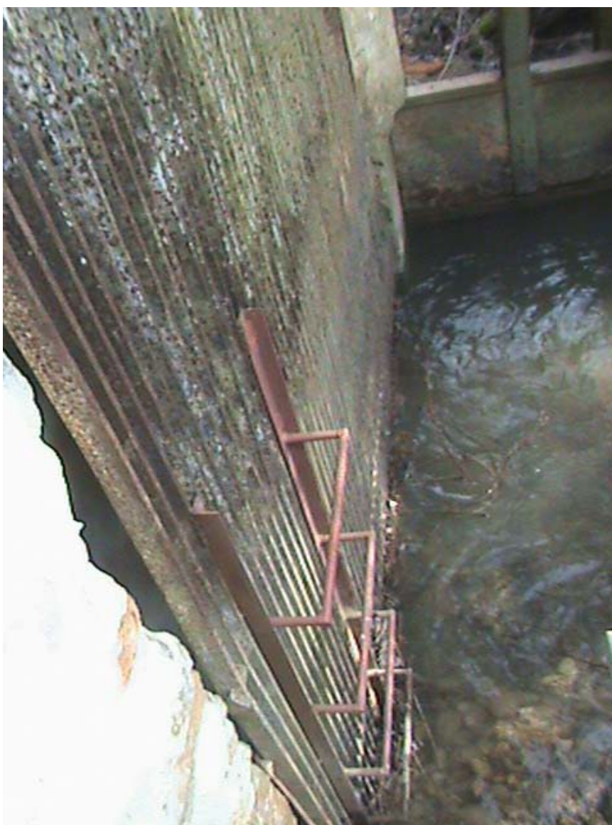
Imagen 2.4.44. Rejilla del azud. Fuente: Estudio de viabilidad de minicentrales provincia de Jaén. AGENER-Universidad de Jaén
