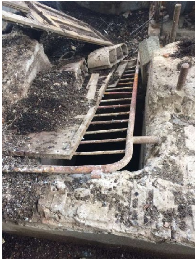
Imagen 2.4.9. Sala de máquinas. Fuente: Estudio de viabilidad de minicentrales provincia de Jaén. AGENER-Universidad de Jaén
