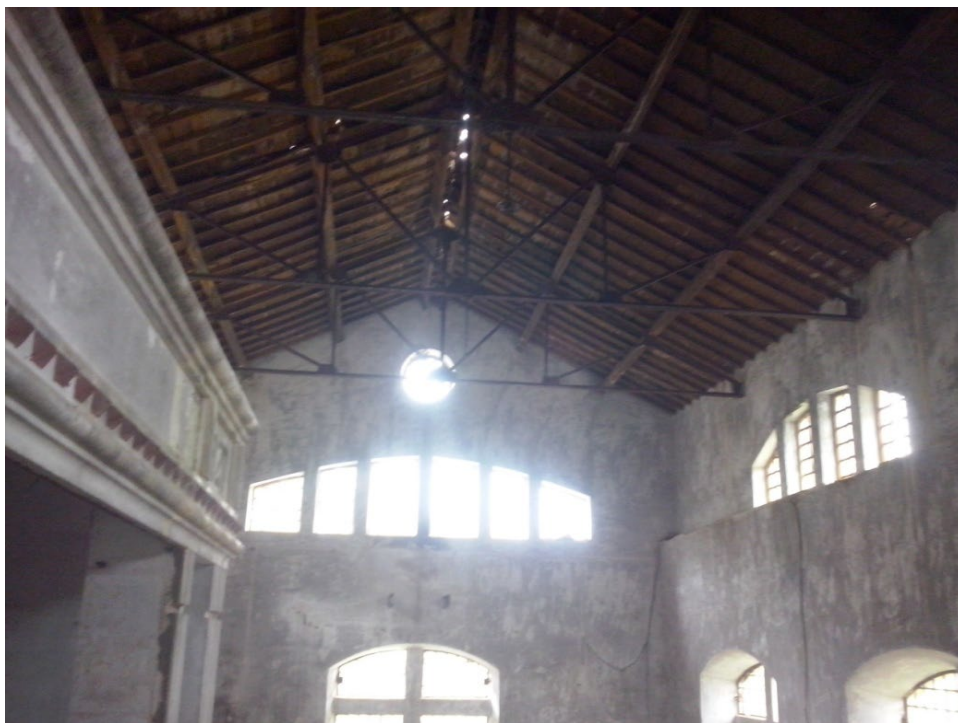
Imagen 2.4.10. Sala de máquinas. Fuente: Estudio de viabilidad de minicentrales provincia de Jaén. AGENER-Universidad de Jaén
