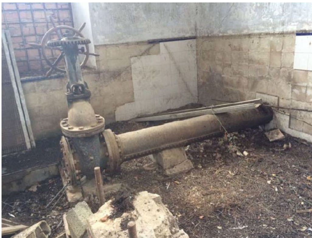
Imagen 2.4.8. Sala de máquinas. Fuente: Estudio de viabilidad de minicentrales provincia de Jaén. AGENER-Universidad de Jaén
