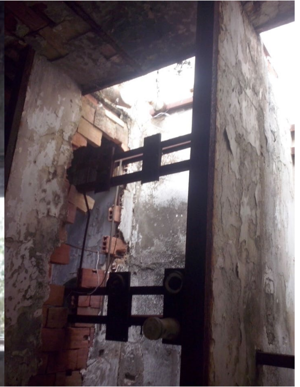
Imagen 2.4.12. Sala de máquinas. Fuente: Estudio de viabilidad de minicentrales provincia de Jaén. AGENER-Universidad de Jaén.
