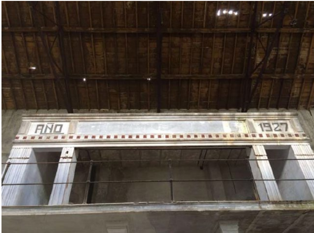
Imagen 2.4.7. Sala de máquinas. Fuente: Estudio de viabilidad de minicentrales provincia de Jaén. AGENER-Universidad de Jaén
