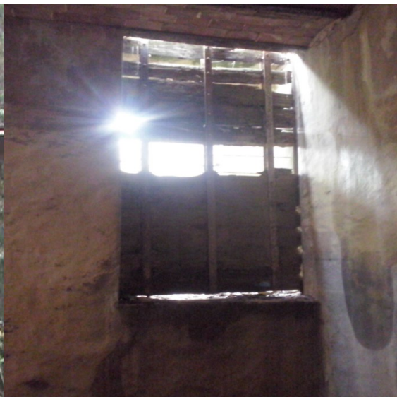
Imagen 2.4.43. Compuerta de entrada a cámara de carga. Fuente: Estudio de viabilidad de minicentrales provincia de Jaén. AGENER-Universidad de Jaén
