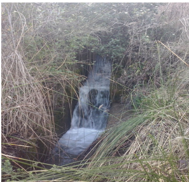
Imagen 2.4.47. Canal aliviadero. Descenso del canal aliviadero. Fuente: Estudio de viabilidad de minicentrales provincia de Jaén. AGENER-Universidad de Jaén
