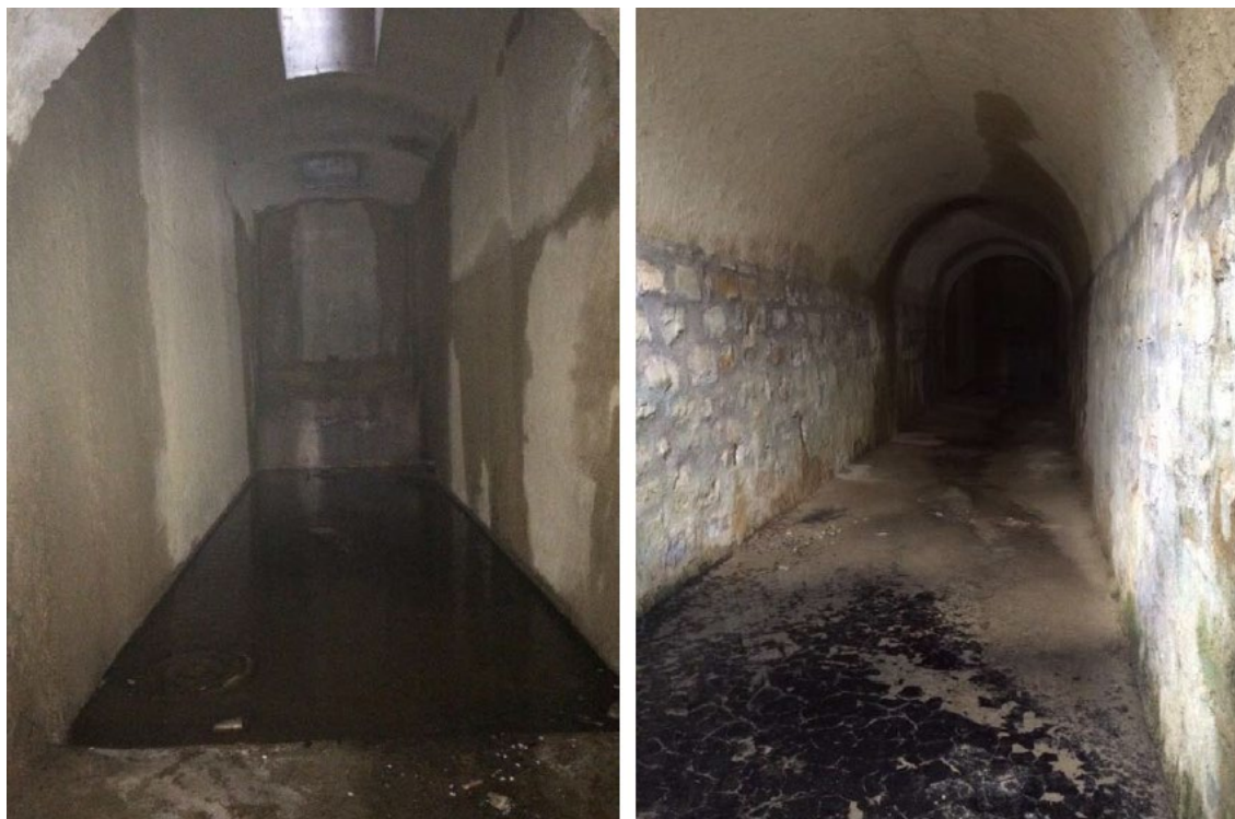
Imagen 2.4.50. Desagüe de la central. Foso de turbinas, salida de las dos turbinas.
