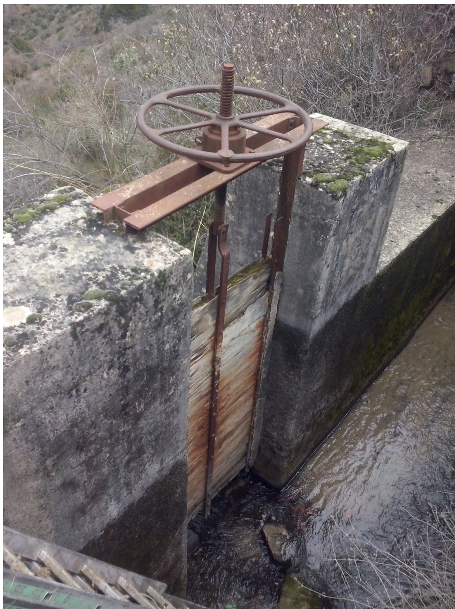
Imagen 2.4.41. Compuerta del canal de desagüe. Fuente: Estudio de viabilidad de minicentrales provincia de Jaén. AGENER-Universidad de Jaén
