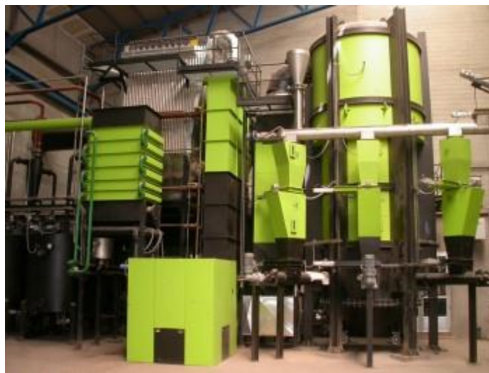
Figura 3.27: Gasificador de la planta de Movialsa.
