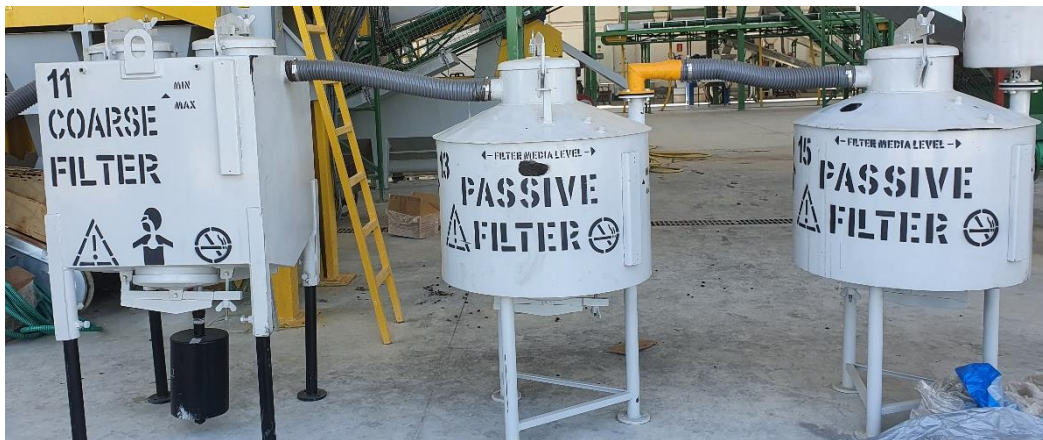
Figura 4.12: Filtros de finos y humedad del proyecto OLIVEN
