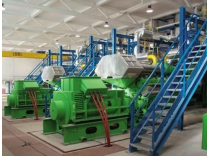
Figura 3.28: Generadores de la instalación.
