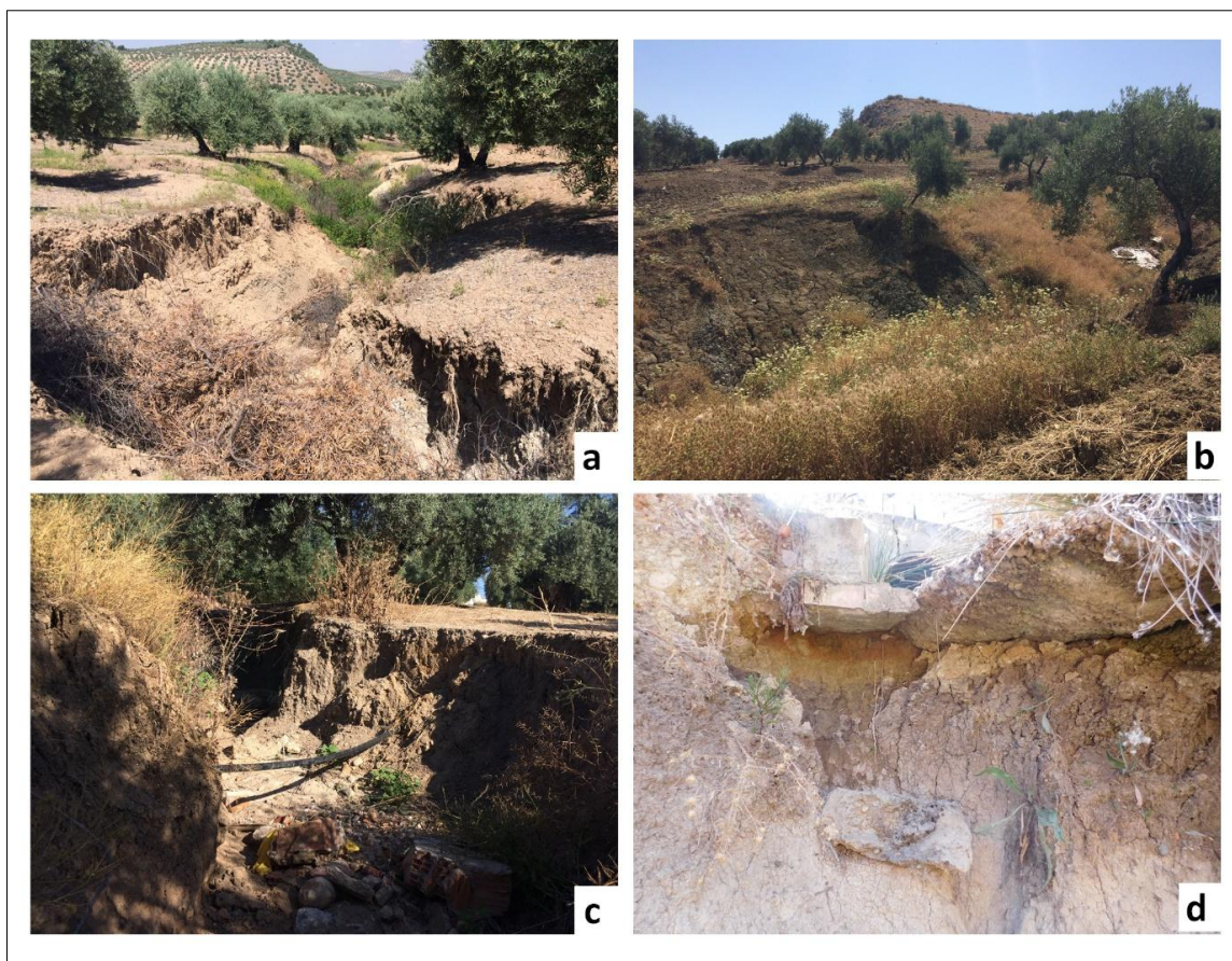
Figura 13. Cárcavas de a) Torredelcampo llena de podas y otros materiales., b) Berrueco con olivo con riesgo de caída en el talud., c) Bailén I con sistema de irrigación expuesto por el proceso erosivo., d) Bailén II con cabecera en la salida de drenaje de la carretera.
