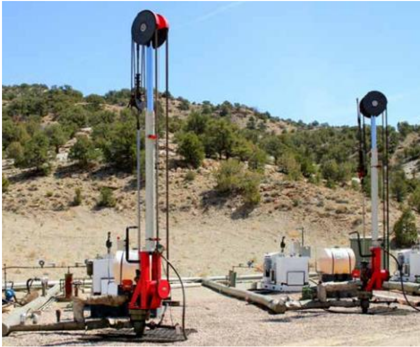
Figura 50. Unidad de bombeo Corlift. Fuente: (Completion & Production solutions, 2015)
