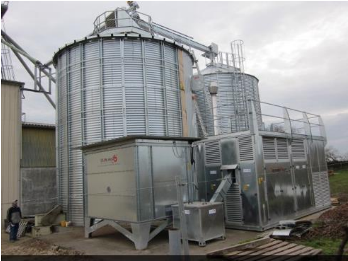
Figura 12 – Secador con caldera de biomasa [21].
