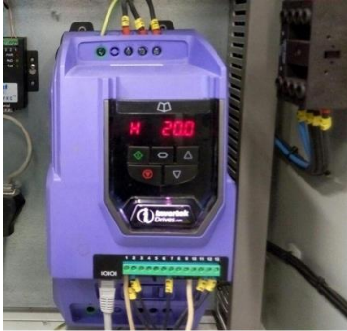
Ilustración 7. Mando variador de frecuencia.
