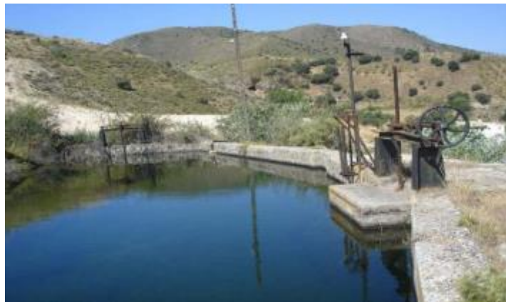
Ilustración 32: Cámara de carga
