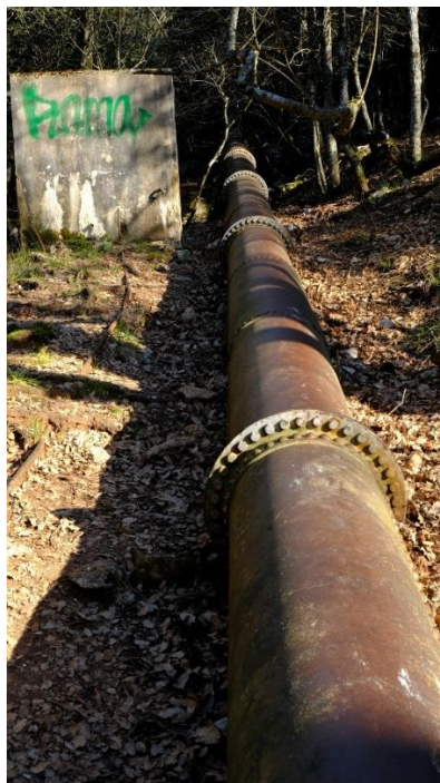
Ilustración 33: Tubería forzada en Sierra de Cazorla
