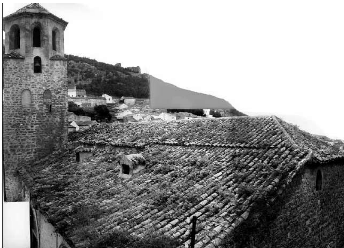
Figura 25. Aspecto deteriorado de la cubierta de la iglesia de la Magdalena antes de su restauración (Berges, 2007: 84).
